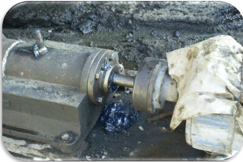
Figura 19. Residuos de grasas y trapos industriales.
