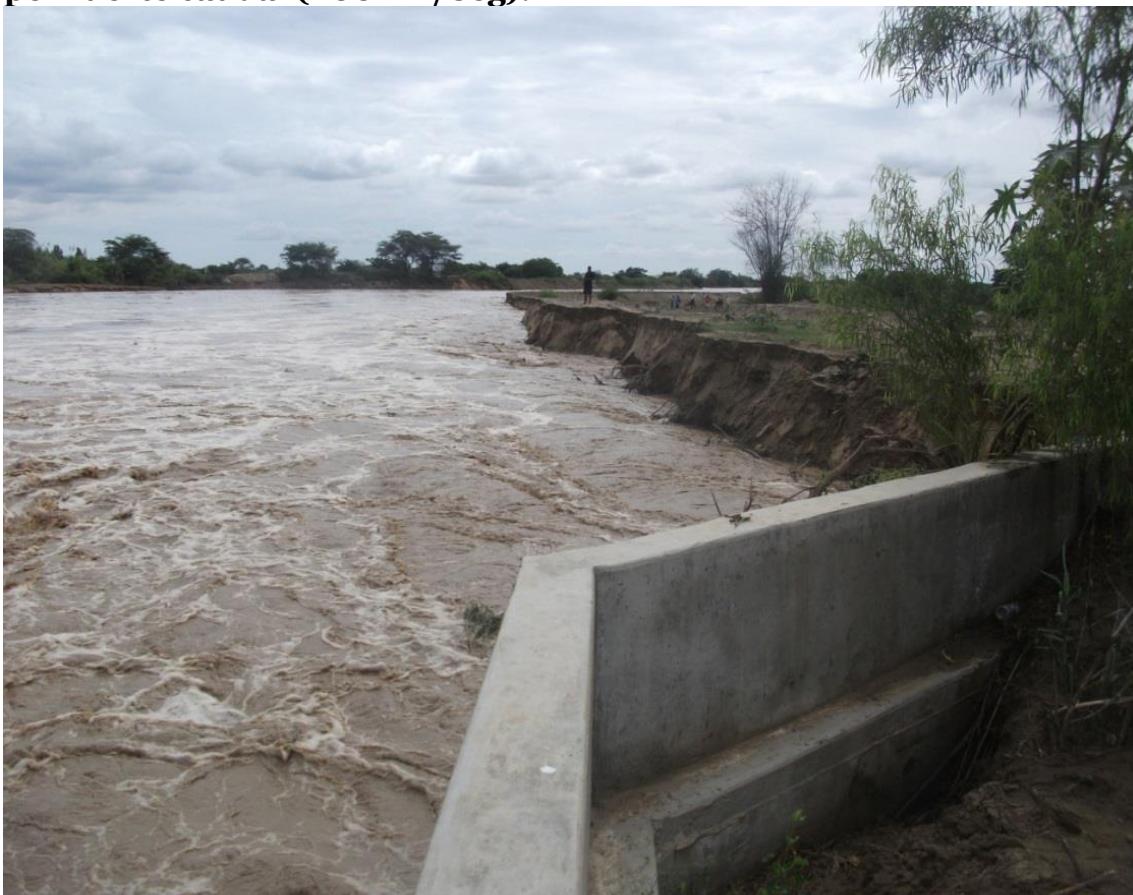
FOTOGRAFÍAS N°2.2: Margen Derecha del Río La Leche erosionada por fuerte caudal (200 m 3 /Seg).
