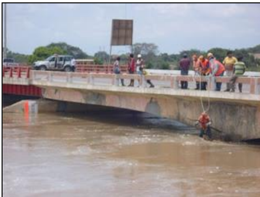
Fig. 10: Nivel de agua alcanzado en el puente
