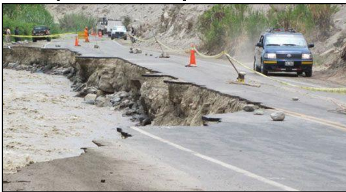
Fig. 12: Daños ocasionados por el río a la carretera
