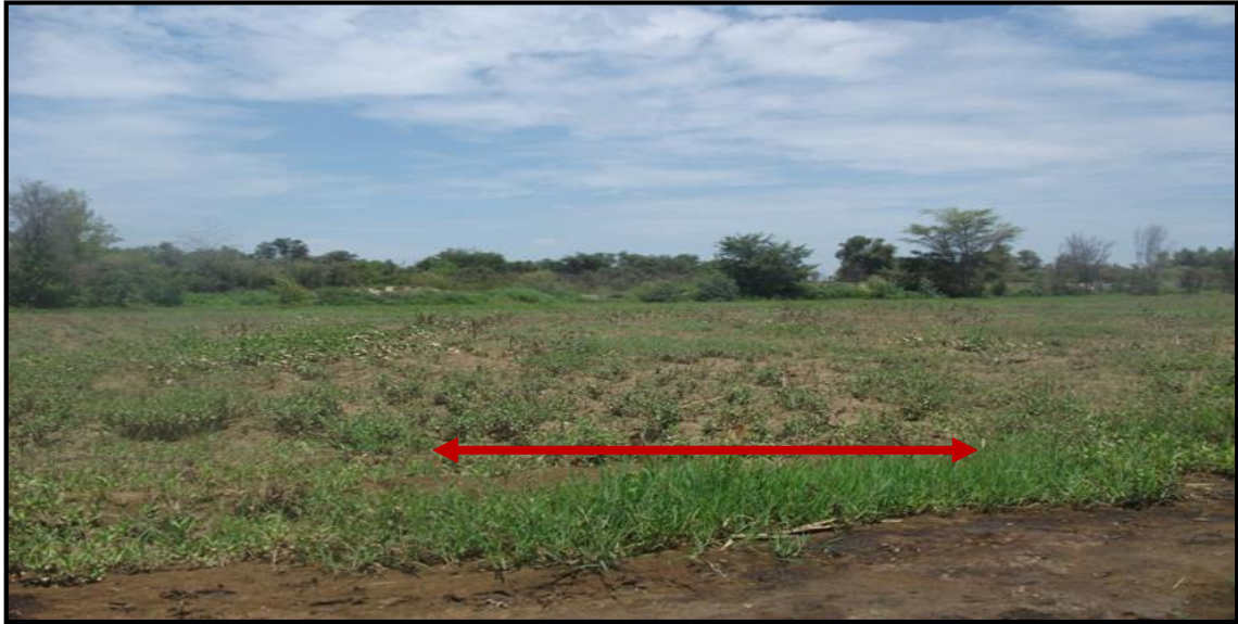
Fig. 29: Vista del dique del lado derecho
