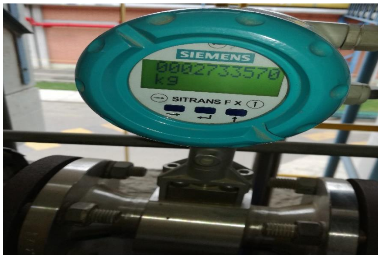
Figura 11. Medidor de vapor
