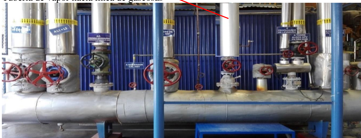
Figura 16. Manifold de distribución de vapor para las diferentes líneas de proceso que tiene la planta industrial
