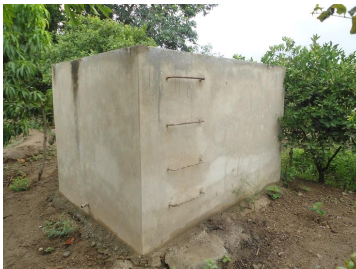
Foto N° 26 Contenedor de Agua – Fundo Augusto
