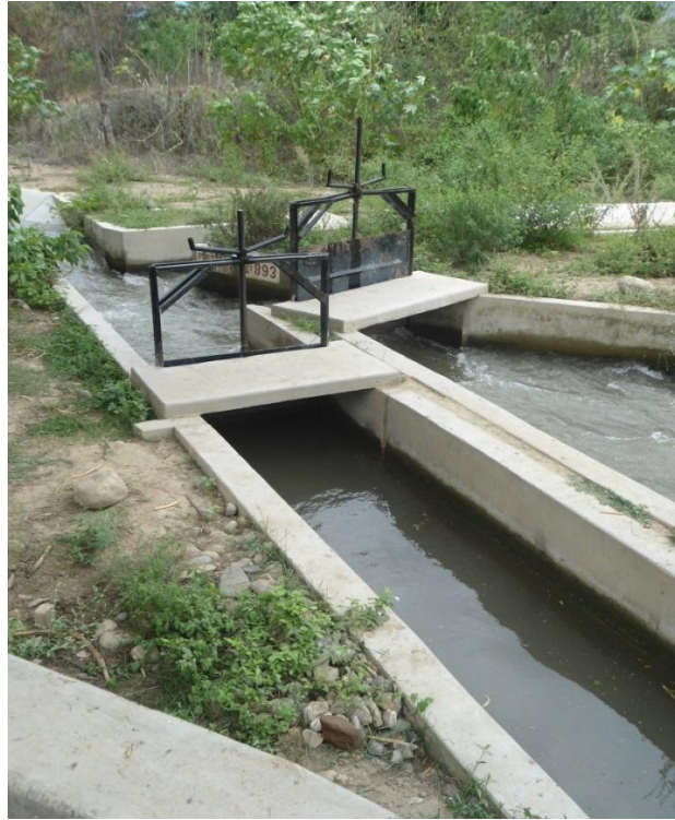
Foto N° 21 Compuertas del canal de irrigación Motupe
