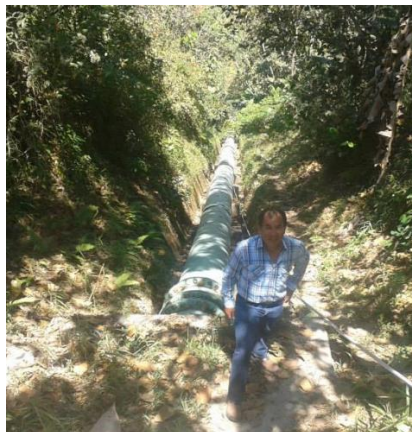
Figura 4 Tubería de presión
