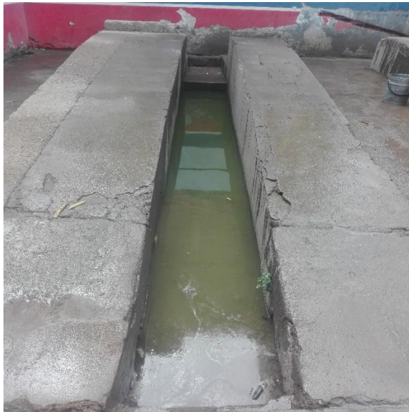
Figura N° 8: Canal para dirigir el agua residual
