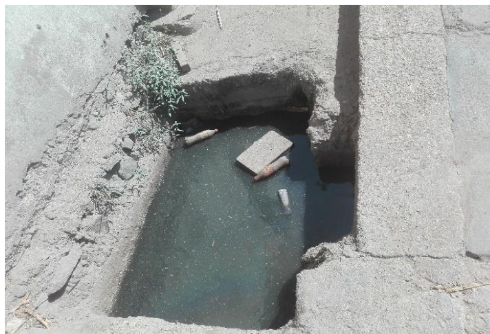
Figura N° 9: Pozo de sedimentado de aguas residuales del Servicentro San Miguel
