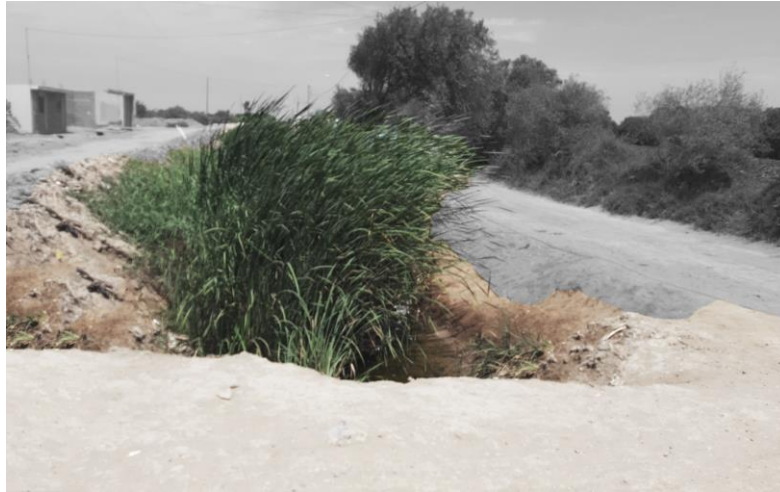
Ilustración 30. Dren 500 con vegetación aglomerada que impide el fluido de las aguas residuales. Fuente: Elaboración propia.
