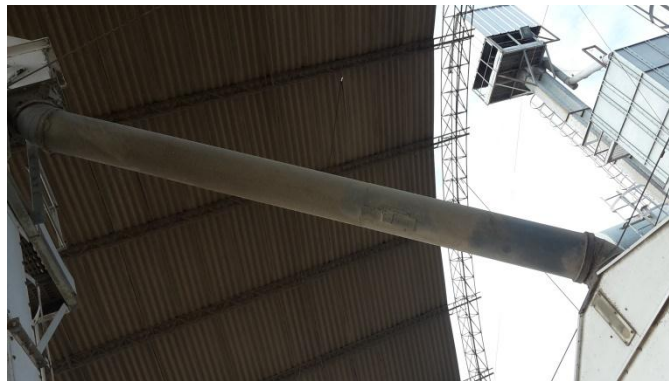
Ilustración 7: Tubo de transporte del elevador de cangilones hacia la máquina pre-limpiadora.
