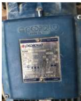
Figura 11. Bomba de agua.
