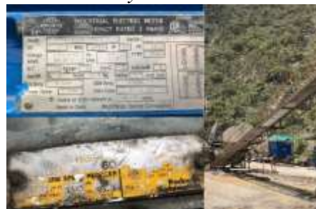
Figura 21. Placa del reductor y motor de la cinta transportadora (8).
