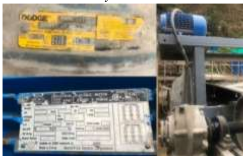
Figura 14. Placa del reductor y motor de la cinta transportadora (1).
