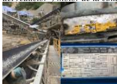
Figura 20. Placa del reductor y motor de la cinta transportadora (7).
