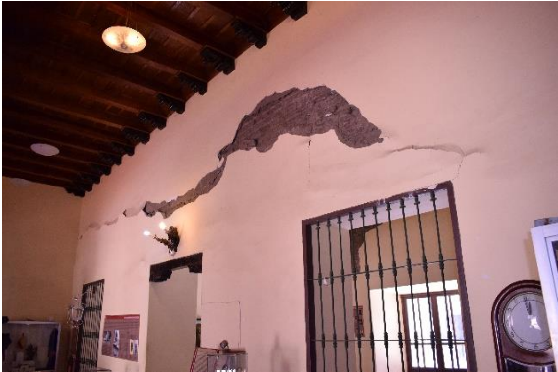
Imagen 39. Ambiente 108. Salón de exposiciones. Fisuras en la parte superior del muro. Fotografía interior de la Casona Montjoy. Fuente Propia
