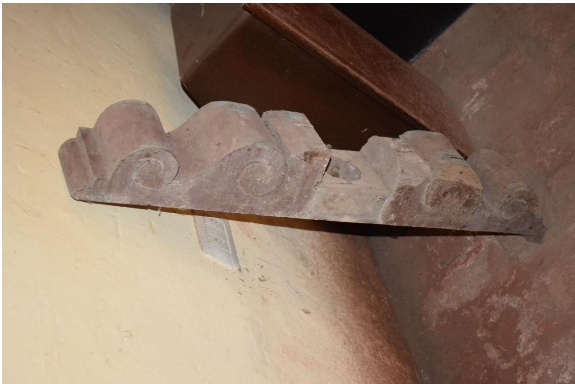
Imagen 59. Vigüeta de soporte para balcones de 90x20 cm aproximadamente. Fuente Propia
