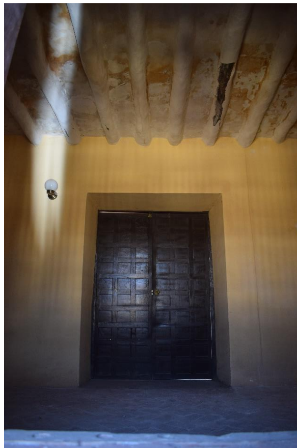
Imagen 50. Ambiente 201. Sin accesibilidad. Fotografía interior de la Casona Montjoy. Fuente Propia
