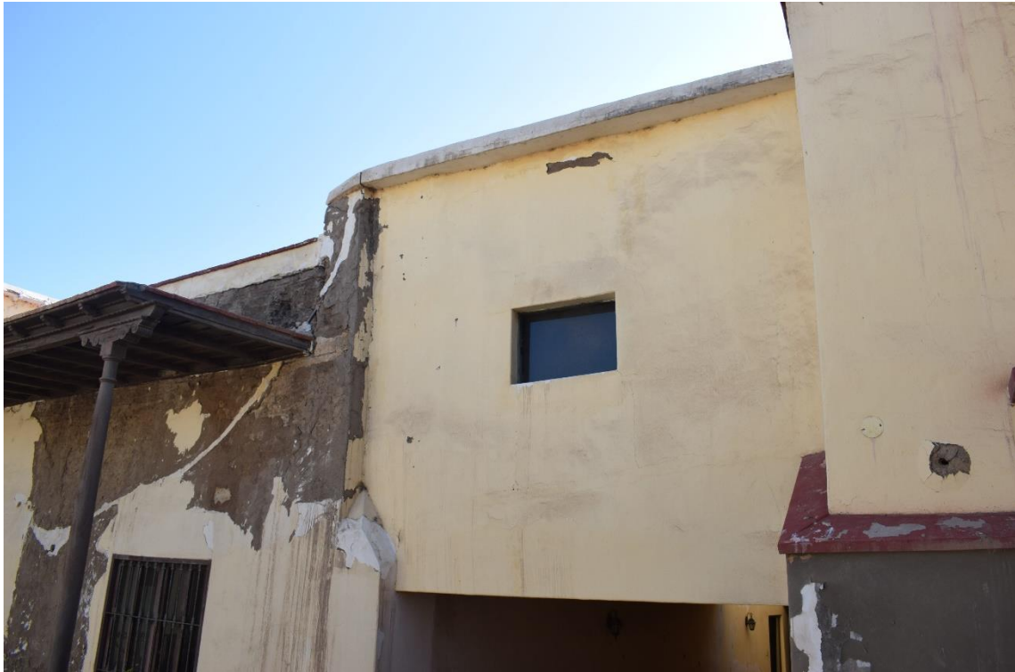
Imagen 37. Ambiente 113. Patio posterior. Fisuras en el muro exterior. Fotografía interior de la Casona Montjoy. Fuente Propia
