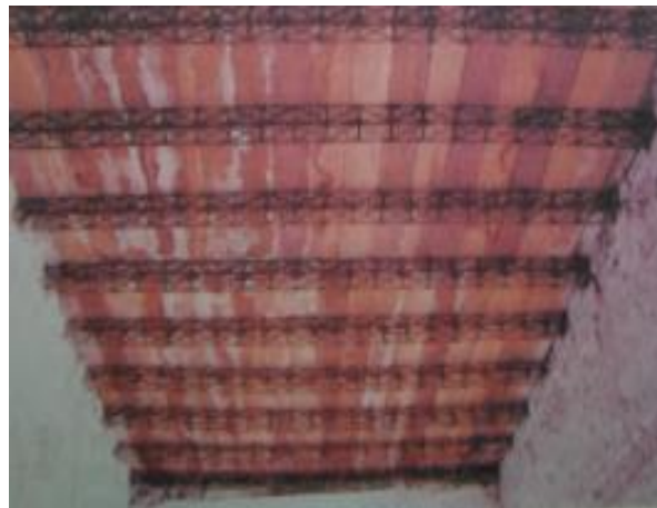
Imagen 20. vigas metálicas arriostradas sobre la cabecera de los muros de adobe. Fotografía Arq. Jorge Cosmópolis
