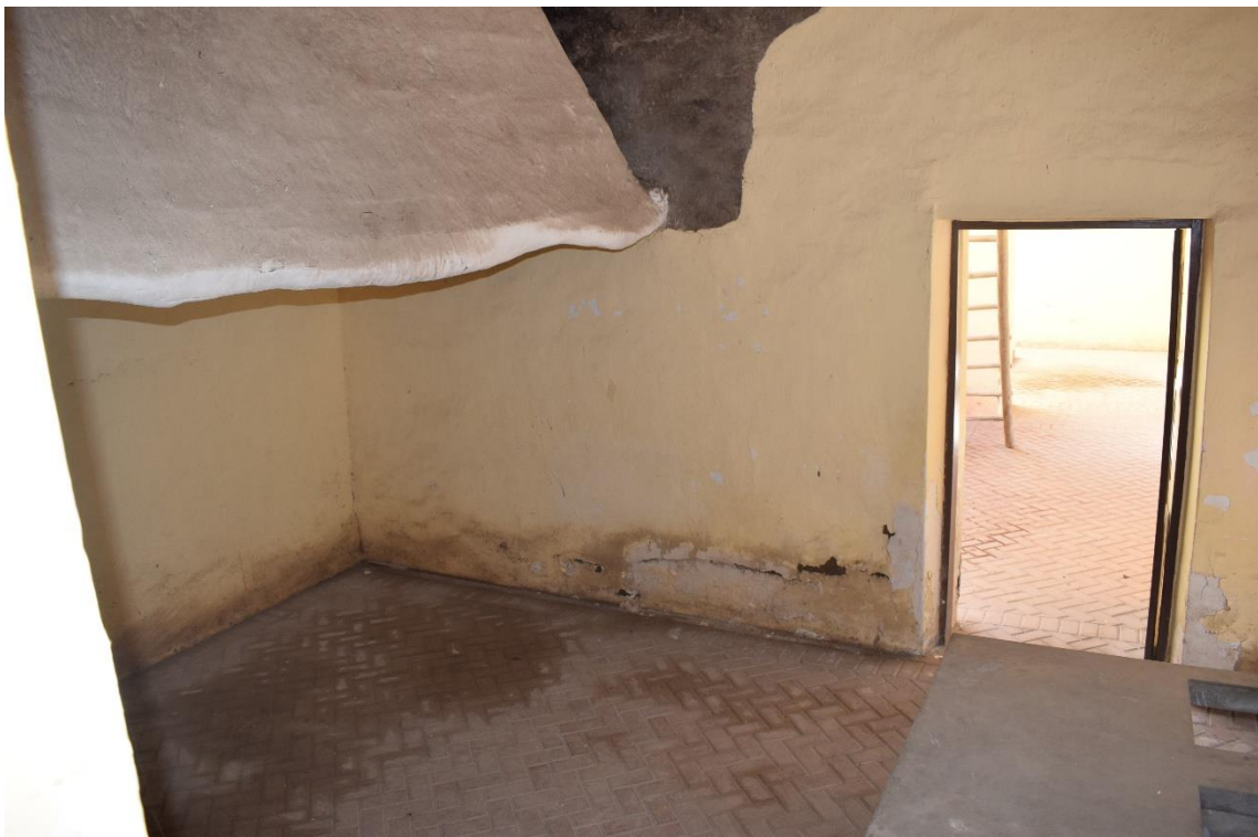
Imagen 38. Ambiente 117. Cocina. Fisuras en el zócalo. Fotografía interior de la Casona Montjoy. Fuente Propia
