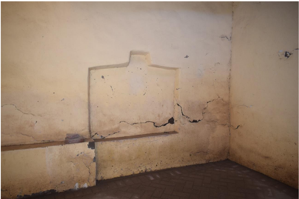
Imagen 40. Ambiente 117. Cocina. Fisuras en el zócalo. Fotografía interior de la Casona Montjoy. Fuente Propia
