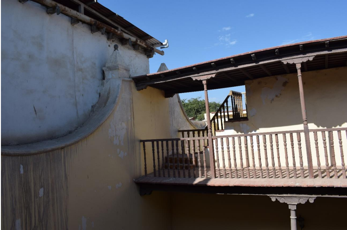
Imagen 41. Ambiente 200. Galería del segundo piso. Fotografía interior de la Casona Montjoy. Fuente Propia
