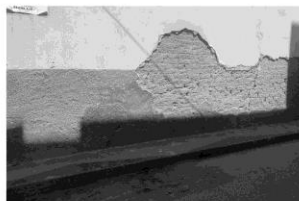
Figura 02: 2019. Fotografía tomada por autor donde se muestra un muro estereotómico de adobe perteneciente a una vivienda en Lambayeque, Perú. Se aprecia a simple vista los ladrillos de adobe espaciales por el deterioro del revoco de cal.
