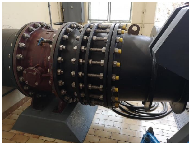
Ilustración 12 Tubería forzada a la entrada de la turbina Fuente: [12]
