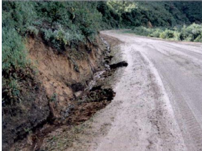
FOTOGRAFÍA N° 3: Cuneta en tierra socavada
