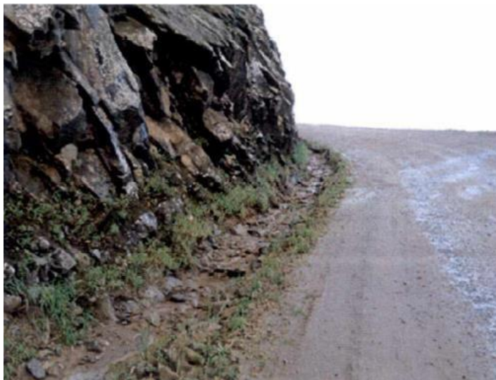
FOTOGRAFÍA N° 4: Cuneta en tierra colmatada
