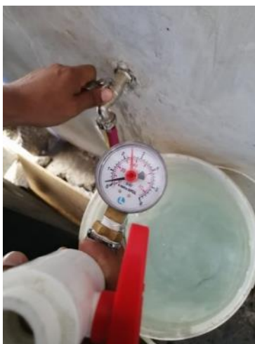
Fotografía 30: Realizando las lecturas manométricas de la presión en la entrada de la vivienda
