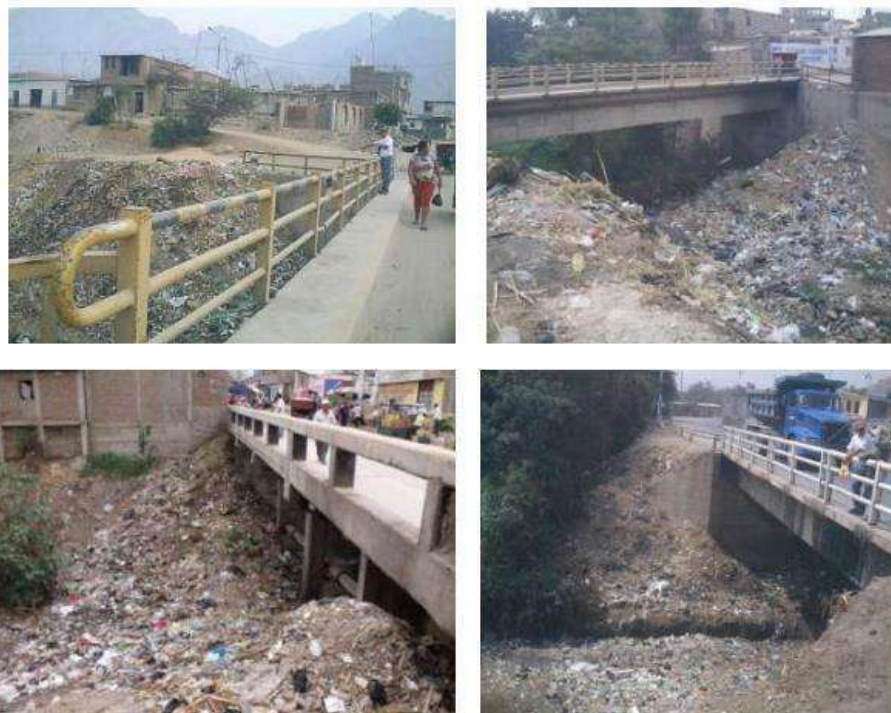
Fotografía N° 03: Basura en el canal Taymi
