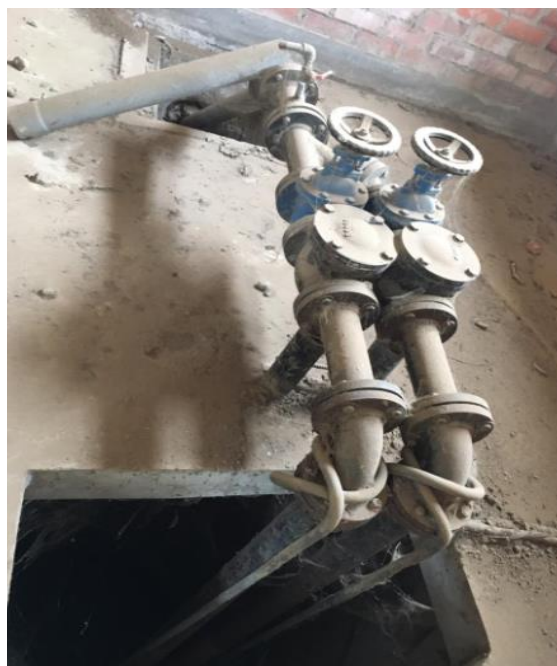
FOTOGRAFÍA N°13.24: Sistema de arrastre hidraulico en el centro poblado Papayo-Desaguadero.
