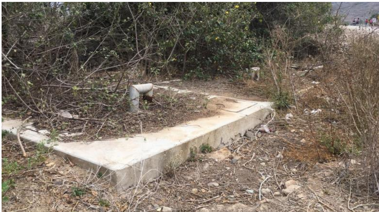
FOTOGRAFÍA N°13.20: Pozo séptico del centro poblado Mayascón.
