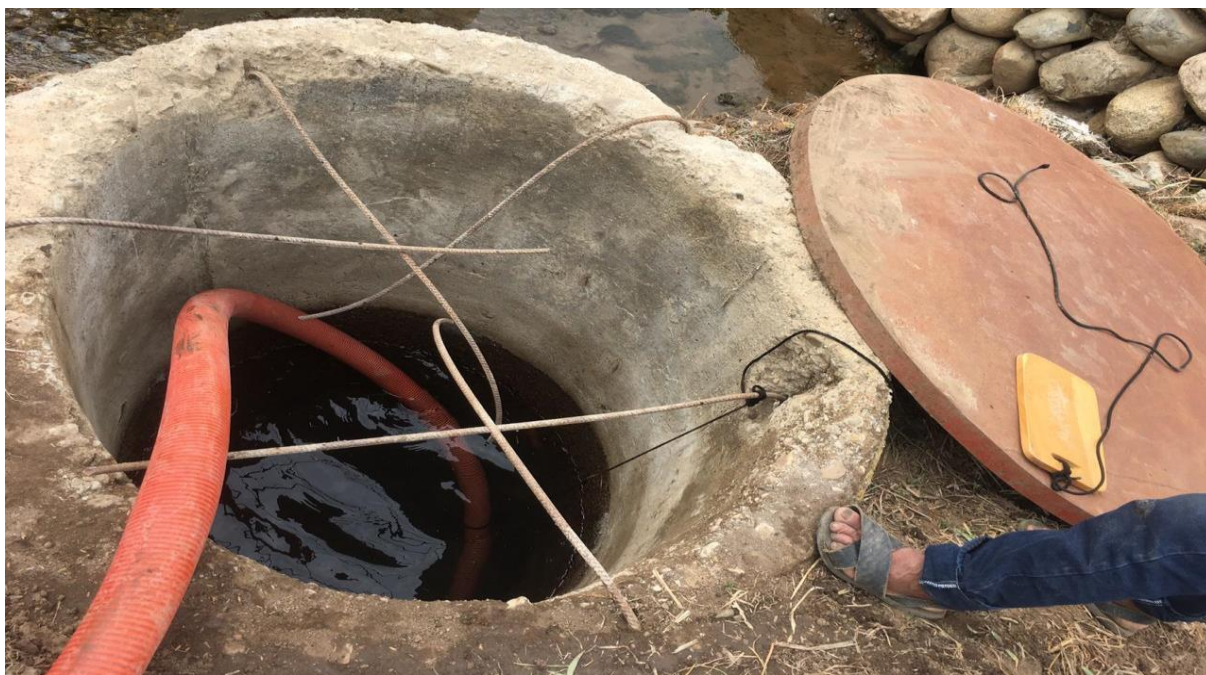
FOTOGRAFÍA N°13.8: Situación actual de Cap. N°01 -Tapa provisional.
