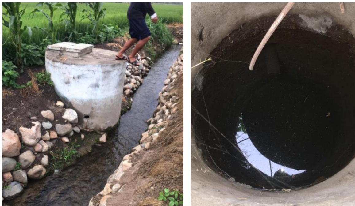
FOTOGRAFÍA N°13.5: Captación 1 manantial de fondo ubicado entre los caseríos Mochumi Alto y Mochumi Bajo.
