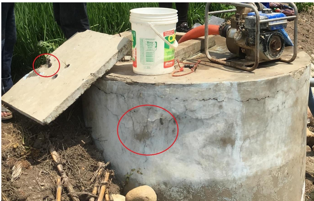
FOTOGRAFÍA N°13.9: Situación actual de Cap. N°02 – Presenta pequeñas fisuras.
