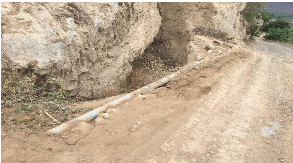
FOTOGRAFÍA N°13.17: Línea de conducción se encuentra expuesta a nivel de trocha.
