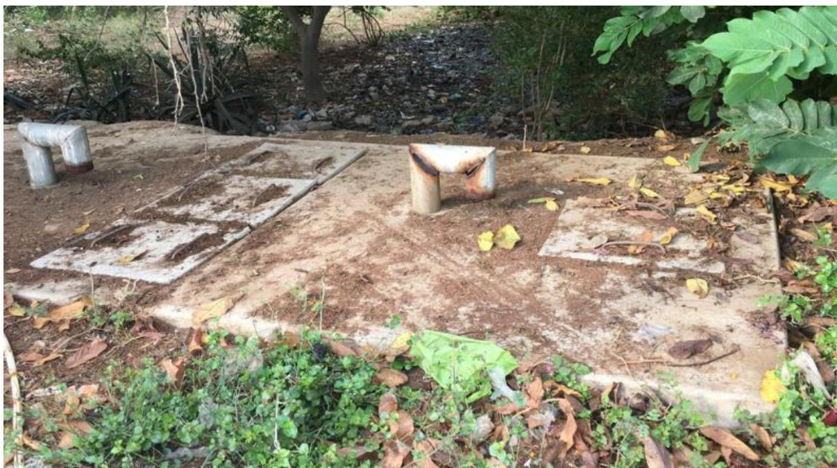
FOTOGRAFÍA N°13.21: Pozo séptico del centro poblado Traposa.
