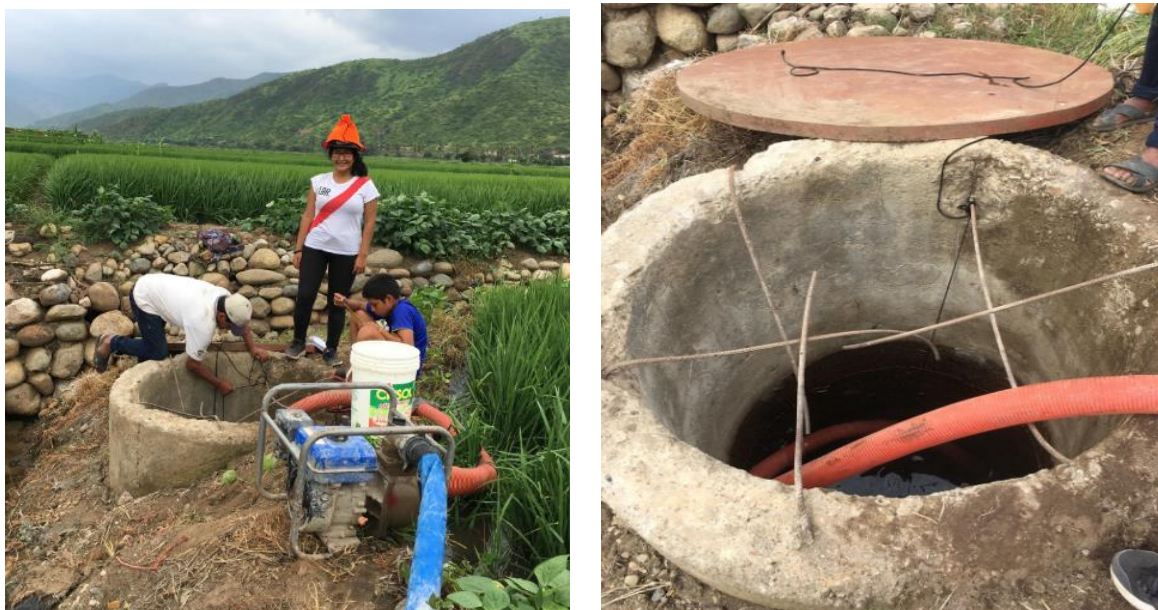
FOTOGRAFÍA N°13.6: Captación 2 manantial de fondo ubicado entre los caseríos Mochumi Alto y Mochumi Bajo.
