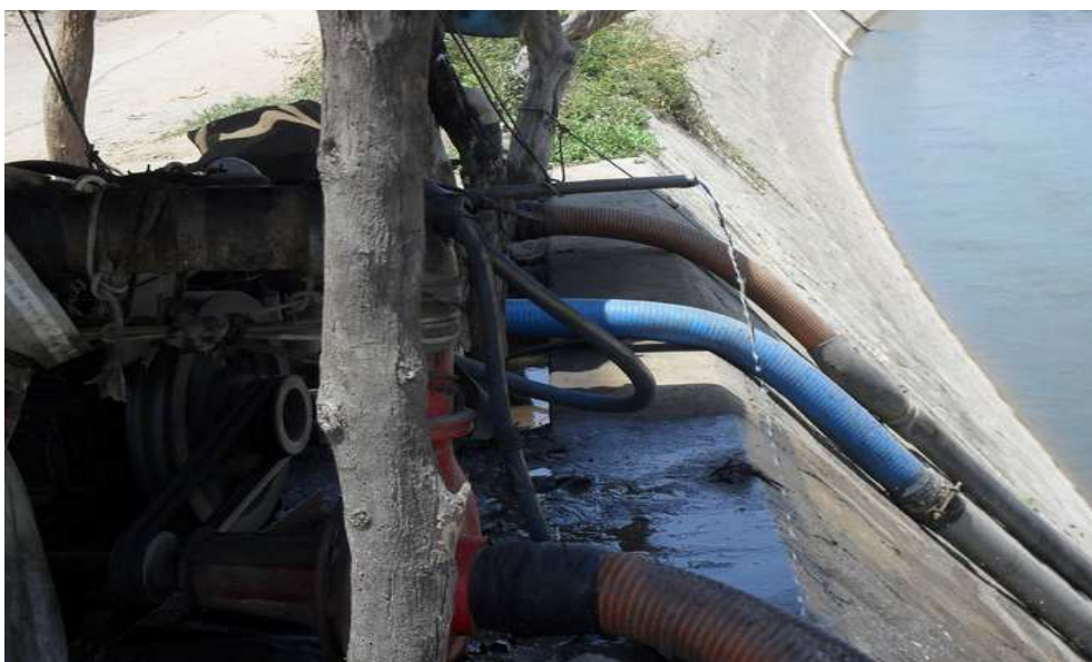
Electrobombas que extraen agua del canal Taymi, evidenciándose fuga de petróleo.
