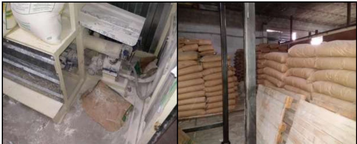
Figura 22. Motor eléctrico expuesto a la humedad, desorden y falta de limpieza de área de trabajo.
