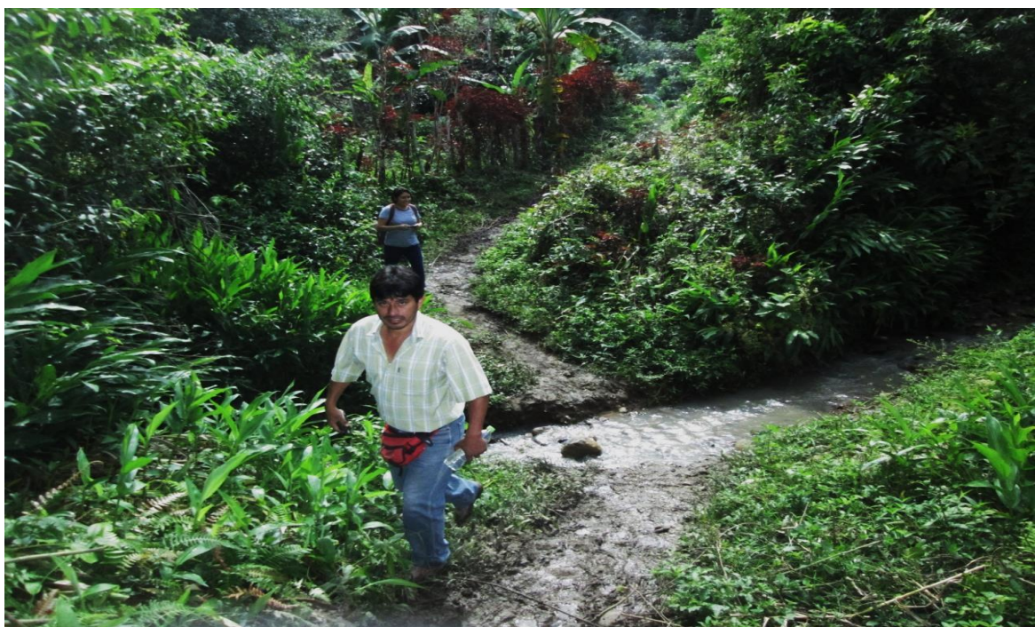
FIGURA 52: NECESIDAD DE OBRA DE ARTE (ALCANTARILLA) POR
