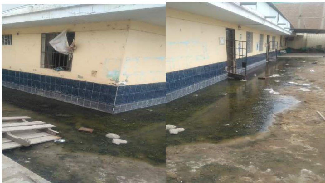
FOTOGRAFÍA N° 4.1: Estado del Centro de Salud de Túcume.
