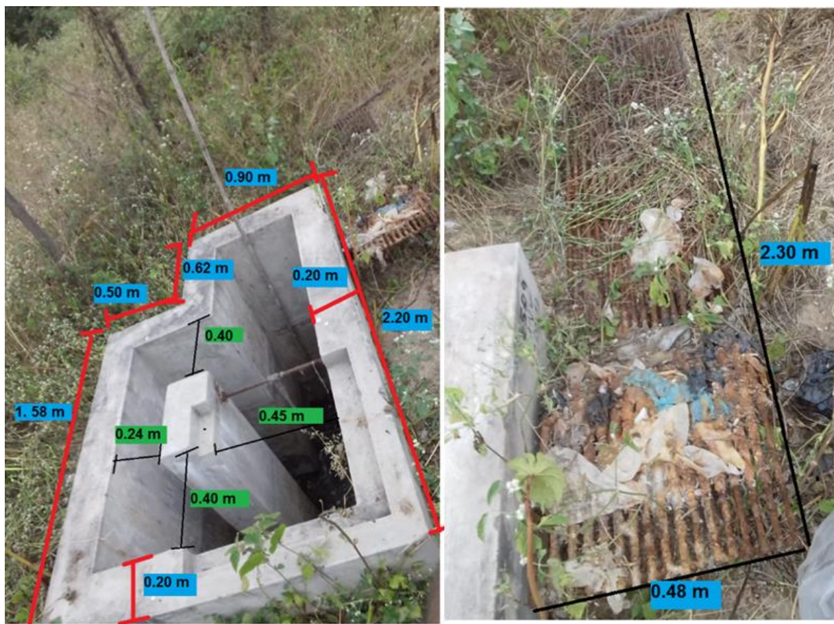
Figura 8. Tratamiento Preliminar: Cámara de rejas
