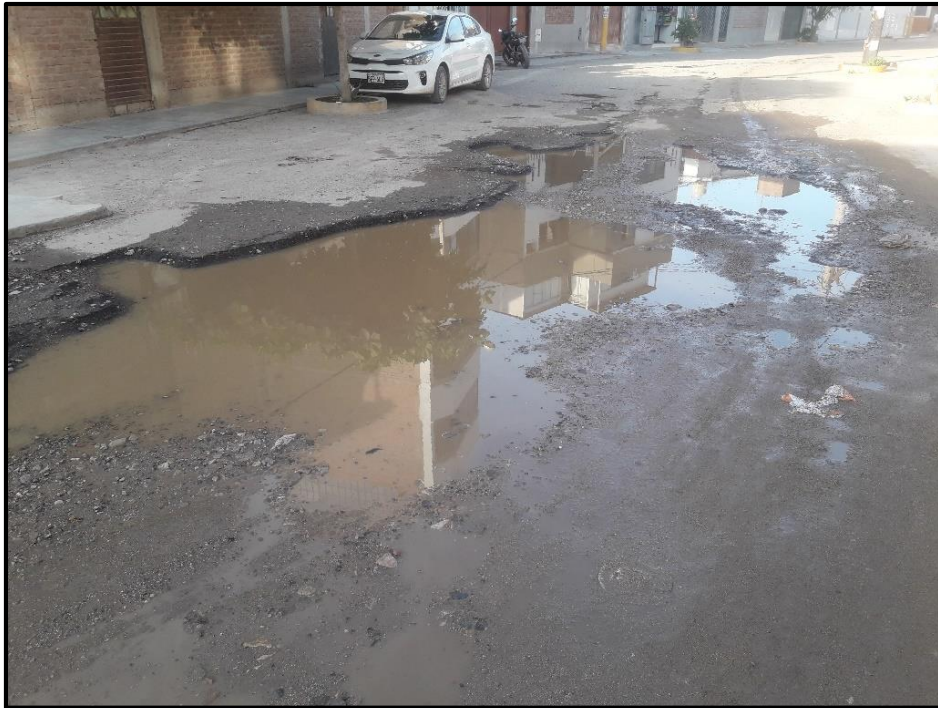
Fotografía 22. Huecos de severidad alta
