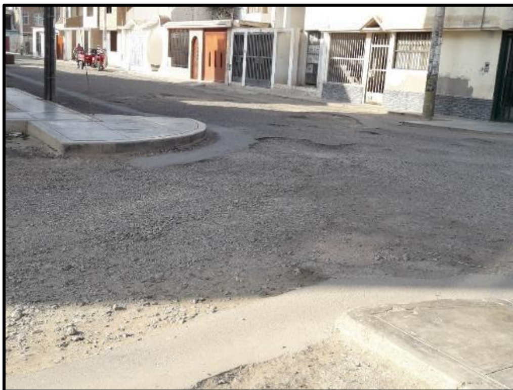
Fotografía 3.7 Estado actual de la intersección W. Rodríguez Reyes y Ordóñez
