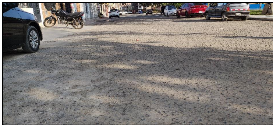
Fotografía 18. Desprendimiento de agregado de severidad media
