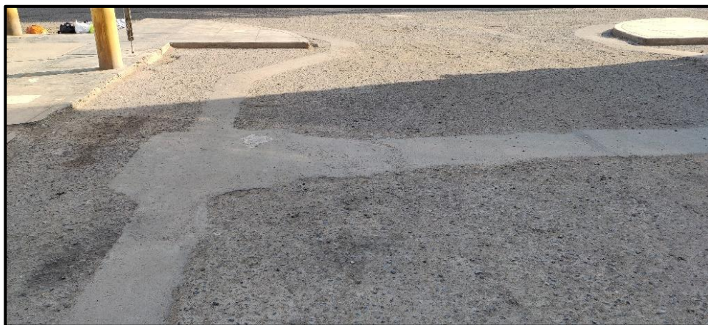
Fotografía 27. Desprendimiento de agregado de severidad media
