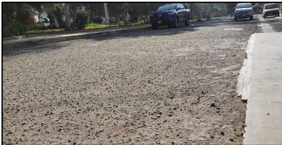
Fotografía 2. Desprendimiento de agregado de severidad media
