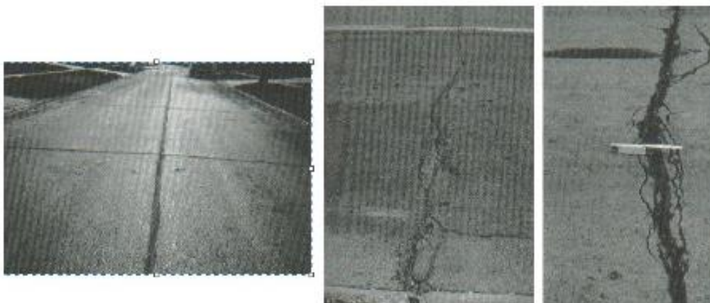
Figura 8. Grieta de reflexión de junta
