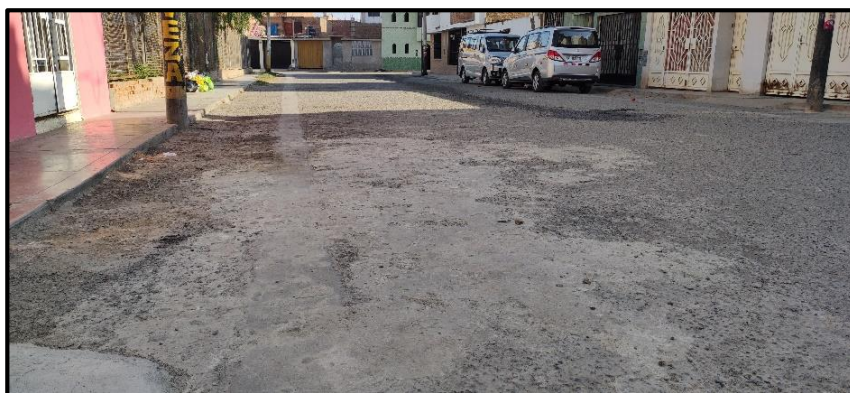
Fotografía 11. Parcheo de severidad media
