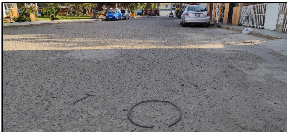
Fotografía 21. Desprendimiento de agregado de severidad media
