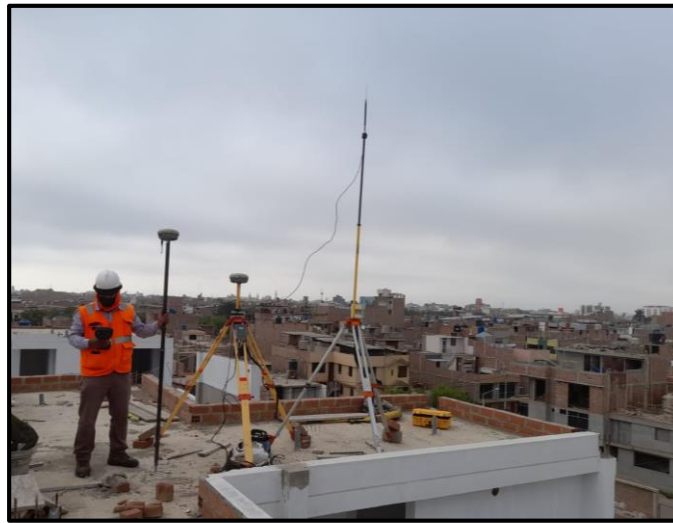
Fotografía 33. Configuración del equipo base
