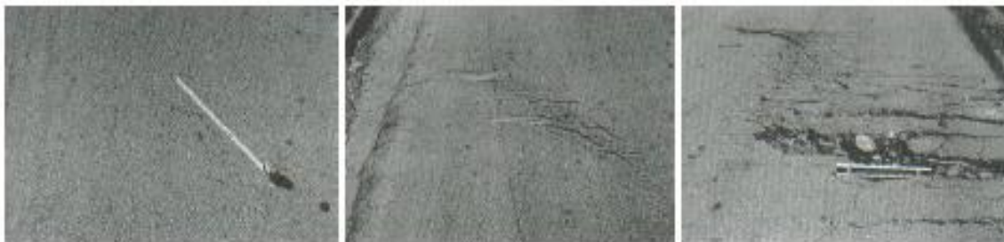
Figura 11. De izquierda a derecha, falla de grietas parabólicas de baja, media y alta severidad
