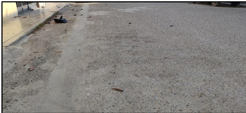
Fotografía 15. Desprendimiento de agregado de severidad media
