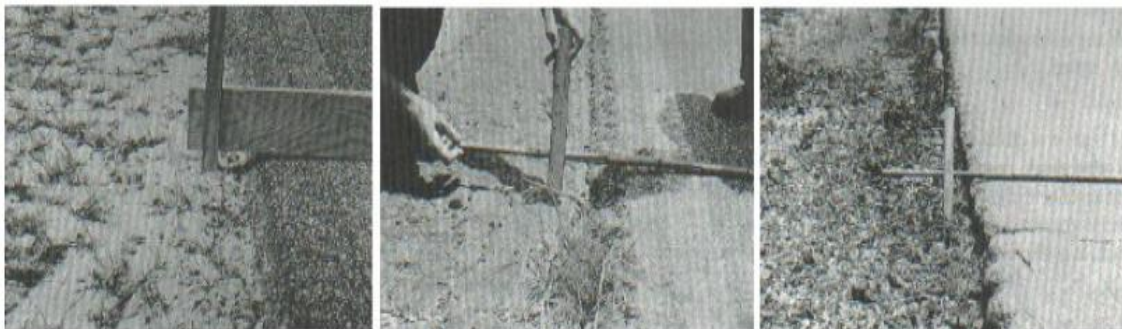
Figura 22. De izquierda a derecha, falla por berma de baja, media y alta severidad
