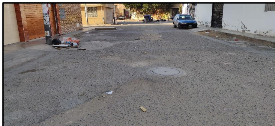
Fotografía 20. Huecos de severidad alta
