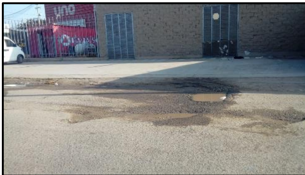
Fotografía 3.5 Estado actual de la calle Eufemio Lora y Lora
