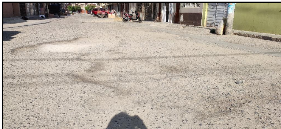
Fotografía 5. Huecos de severidad alta
