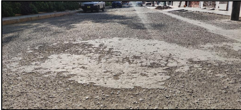
Fotografía 1. Parcheo de severidad alta
