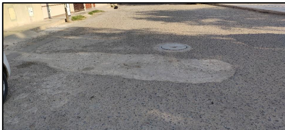
Fotografía 19. Parcheo de severidad alta
