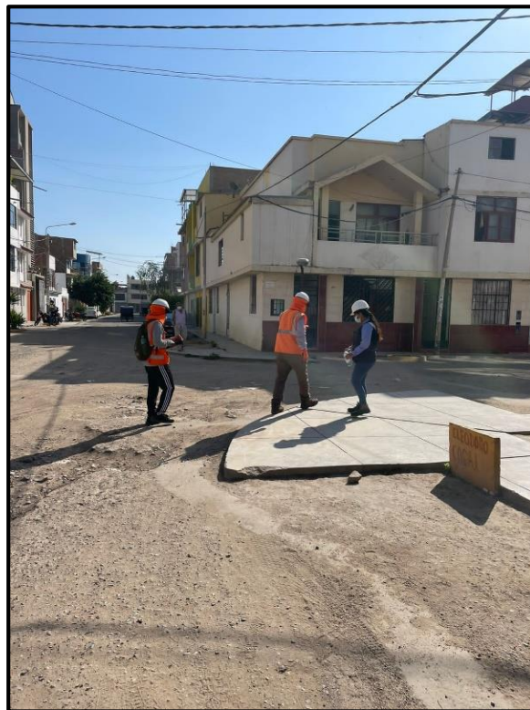
Fotografía 23. Desprendimiento de agregado de severidad alta
