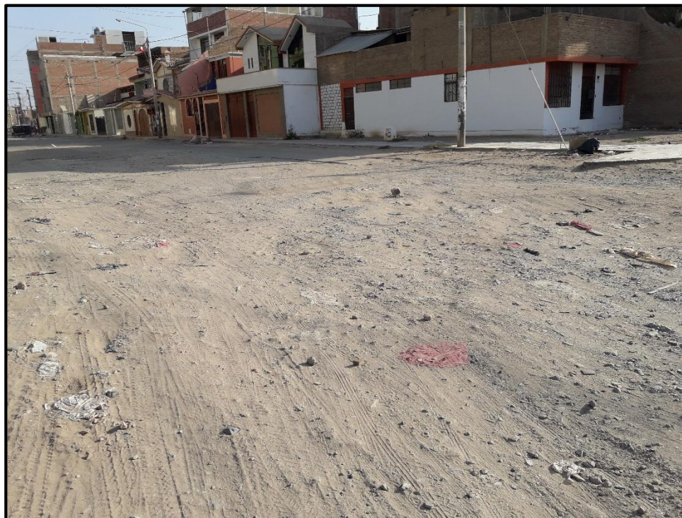
Fotografía 32. Desprendimiento de agregado de severidad alta
