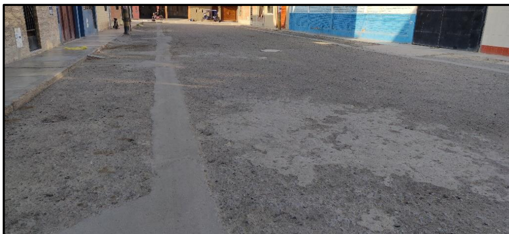
Fotografía 28. Huecos y desprendimiento de agregado de severidad media
