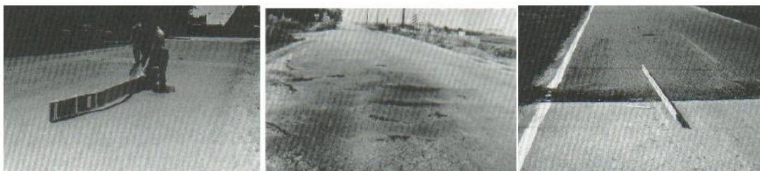
Figura 16. De izquierda a derecha, falla por desplazamiento de baja, media y alta severidad
