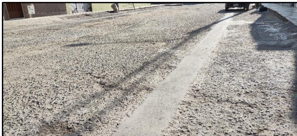
Fotografía 6. Grietas transversales de severidad media
