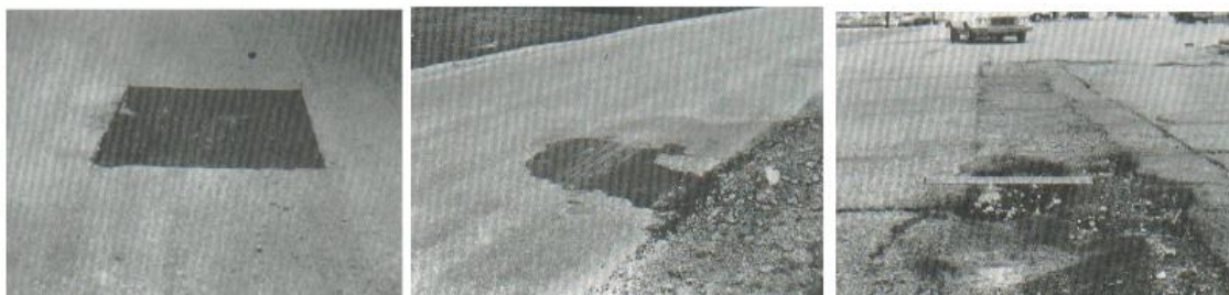
Figura 23. De izquierda a derecha, falla por parcheo y acometida de baja, media y alta severidad
