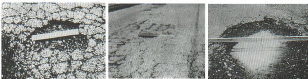
Figura 18. De izquierda a derecha, falla por huecos de baja, media y alta severidad
