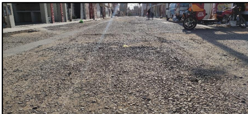
Fotografía 8. Desprendimiento de agregado de severidad alta
