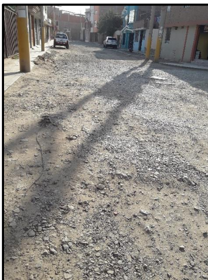
Fotografía 26. Desprendimiento de agregado de severidad alta
