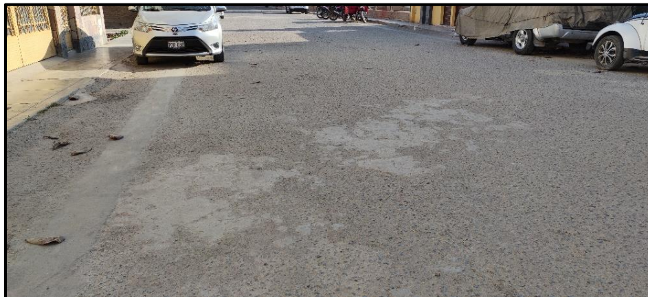
Fotografía 16. Parcheo de severidad media
