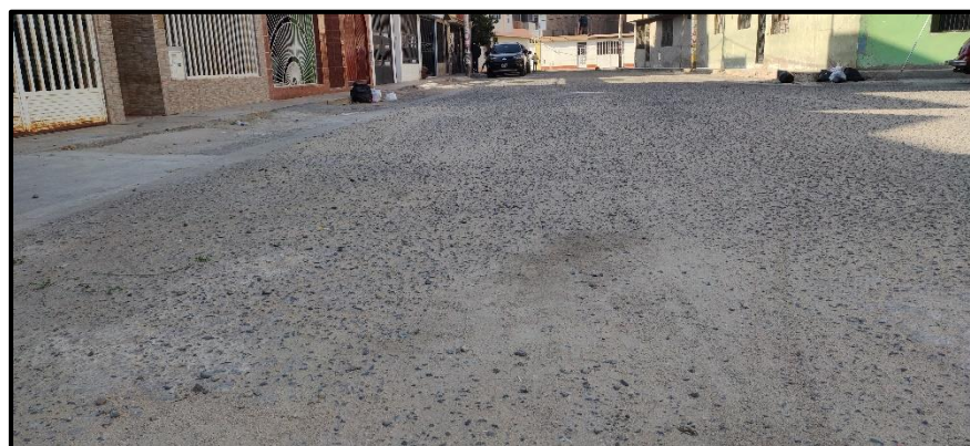
Fotografía 12. Desprendimiento de agregado de severidad leve
