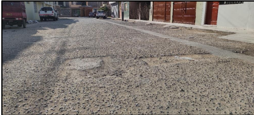
Fotografía 13. Desprendimiento de agregado de severidad leve, huecos de severidad alta
