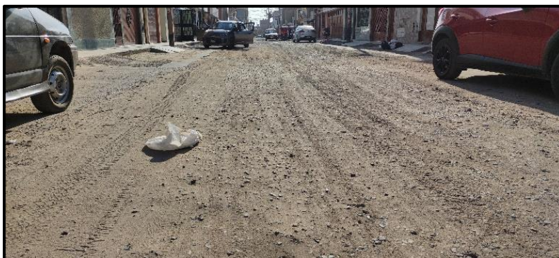
Fotografía 7. Desprendimiento de agregado de severidad alta
