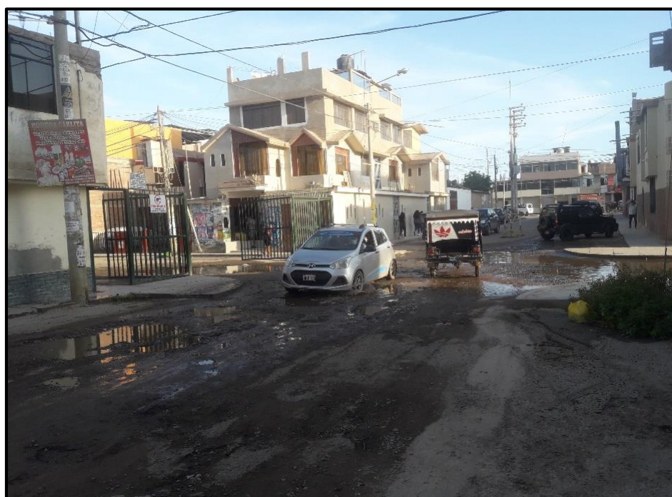
Fotografía 29. Huecos de severidad alta
