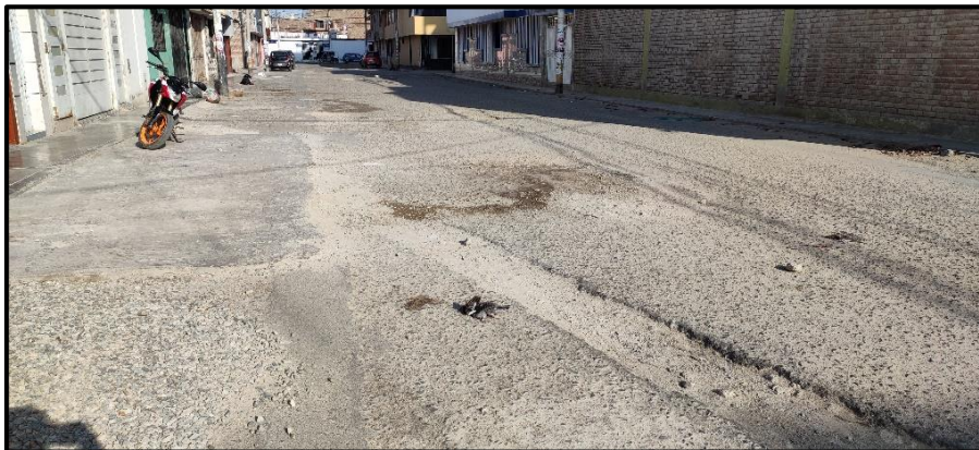
Fotografía 14. Huecos de severidad alta
