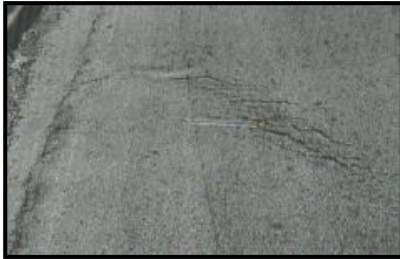
Figura 27- Falla Grietas parabólicas- Severidad media
