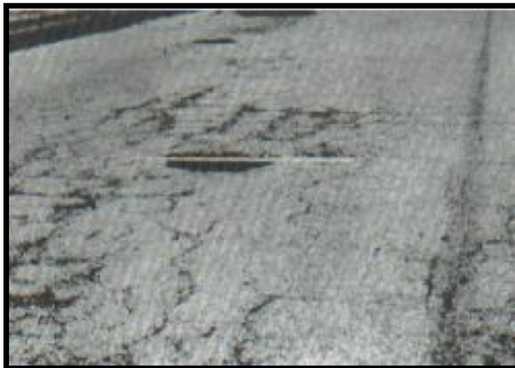
Figura 23- Falla Pulimento de Agregados- Severidad media
