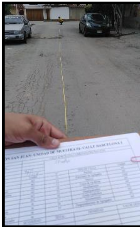
Fotografía 40- Toma de muestra en la calle Barcelona/ Falla de Piel de Cocodrilo
