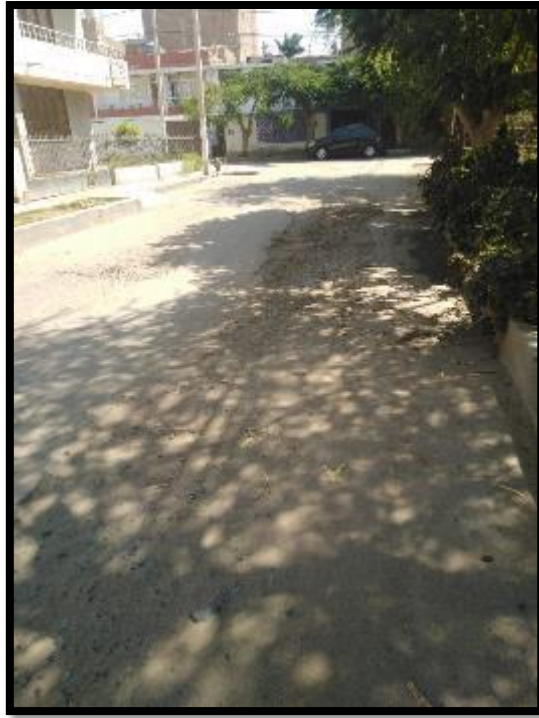
Fotografía 39- Falla de Meteorización y Desprendimiento de Agregados en la calle Cádiz
