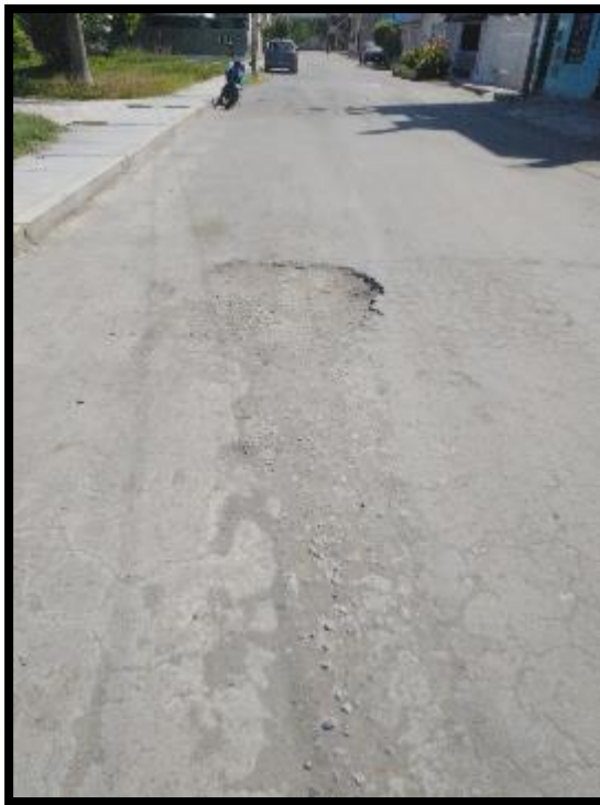
Fotografía 33- Falla de Huevo en la calle Córdoba
