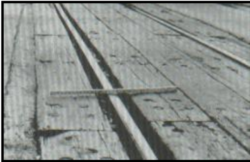
Figura 24- Falla Cruce de Vía Férrea- Severidad media
