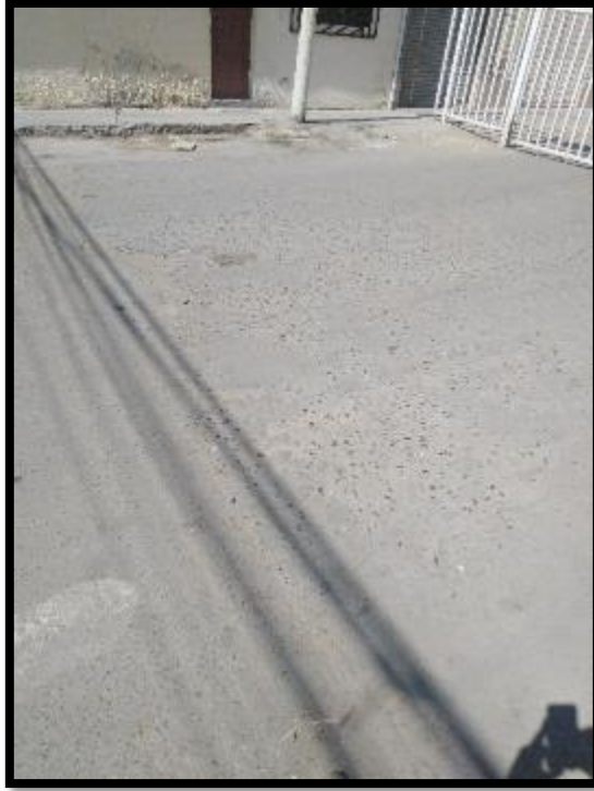
Fotografía 37- Falla de Desprendimiento de Agregado en la calle Asturias
