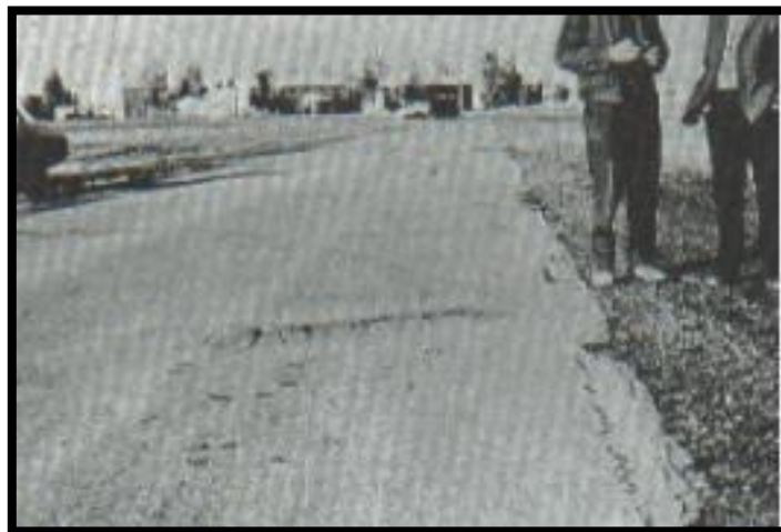
Figura 14- Falla Abultamiento y Hundimiento- Severidad media
