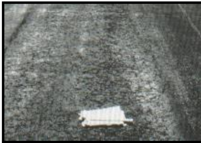
Figura 29- Falla Meteorización- Desprendimiento de Agregados/ Severidad media
