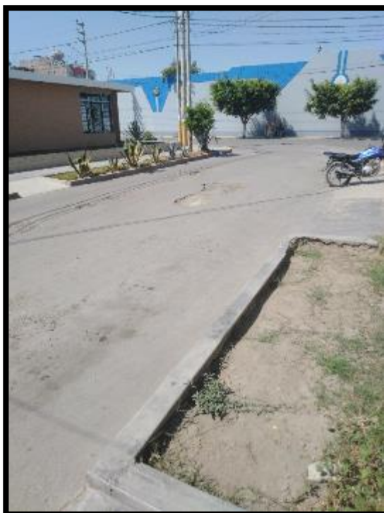
Fotografía 32- Falla de Hueco en la calle Cádiz
