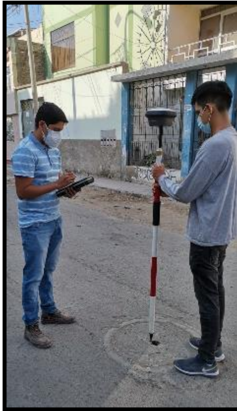
Fotografía 03- Toma de punto de tapa de buzón con el GPS receptor dinámico
