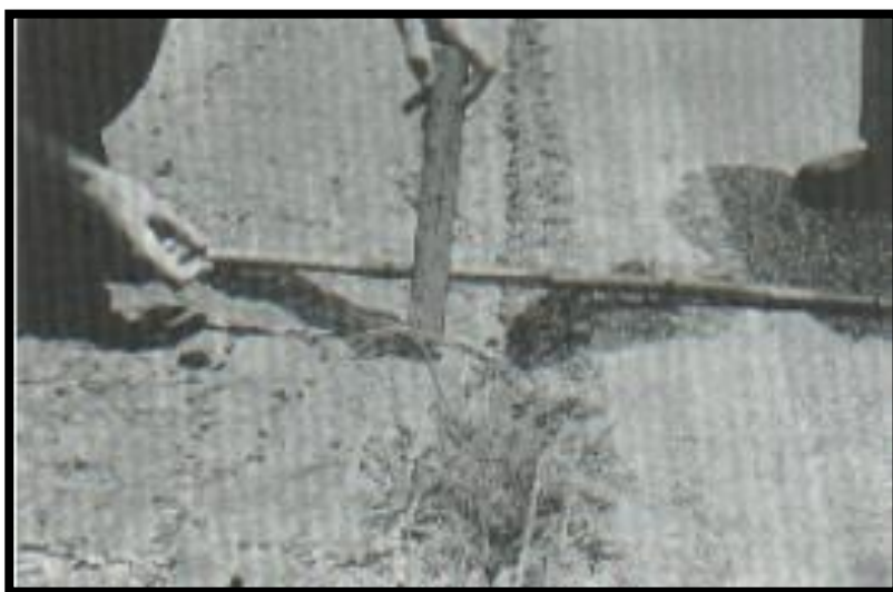
Figura 19- Falla Desnivel Berma y Carril- Severidad media
