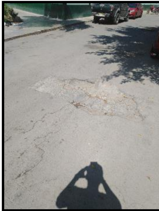
Fotografía 38- Falla de Parcheo en la calle Alcalá
