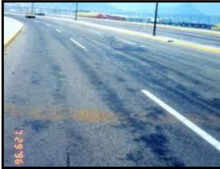
Figura 12- Falla Exudación- Severidad media
