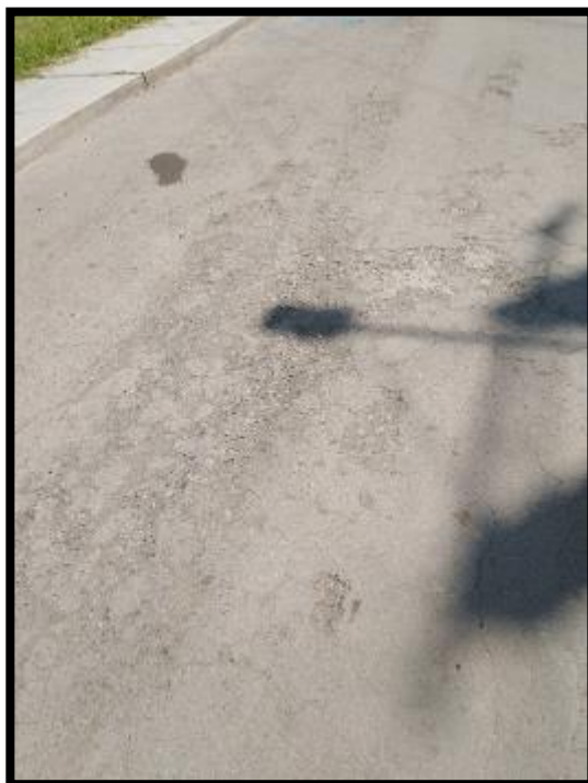
Fotografía 34- Falla de Desprendimiento de Agregados en la calle Córdoba
