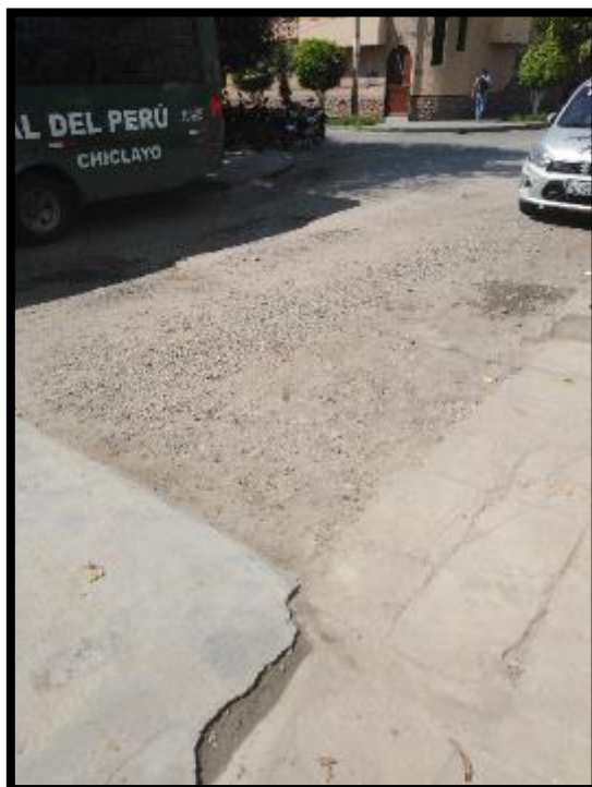
Fotografía 31- Falla de Meteorización en la calle Cádiz
