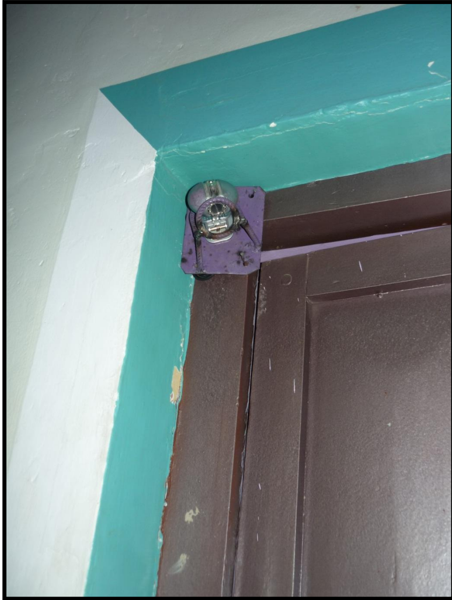
Cámara instalada con protección.
