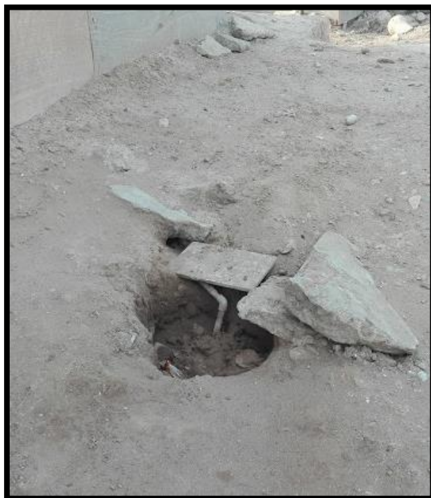
Fotografía 9.8. Conexiones de Agua Clandestinas.
