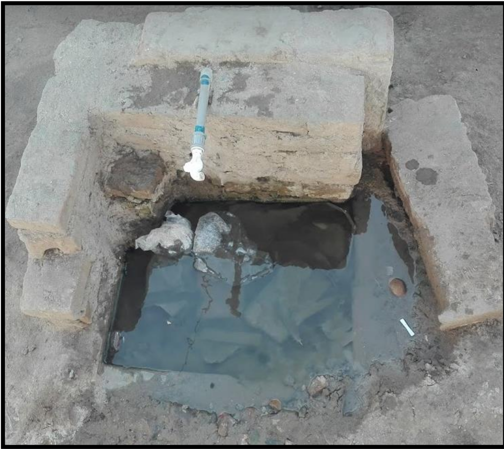
Fotografía 9.3. Pileta Para Abastecimiento de Agua.
