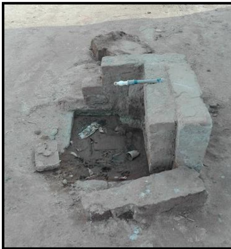
Fotografía 9.5. Pileta Para Abastecimiento de Agua.
