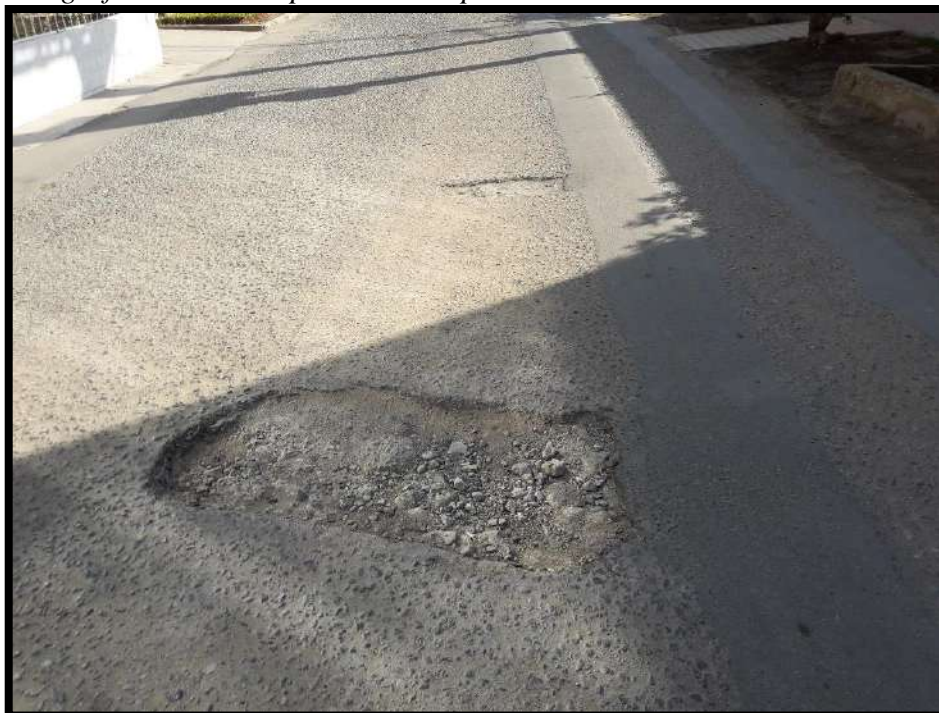
Fotografía 3 – Falla tipo bache del pavimento en la Calle Horacio Patiño
