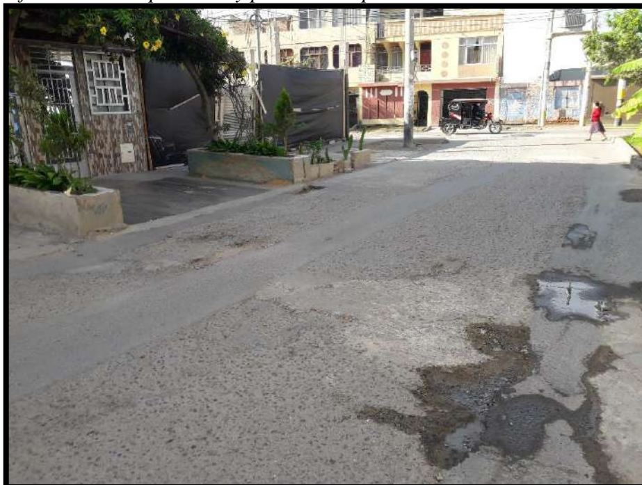
Fotografía 4 – Falla tipo bache y parcheo del pavimento en la Calle Horacio Patiño
