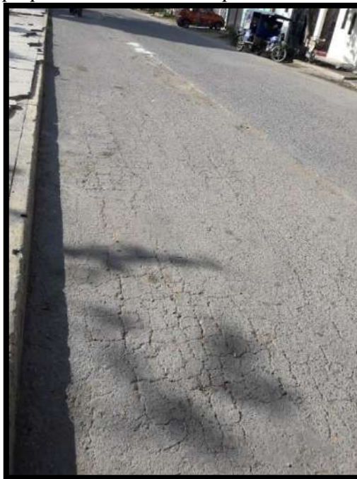
Fotografía 5 – Falla tipo piel de cocodrilo del pavimento en la Calle Horacio Patiño
