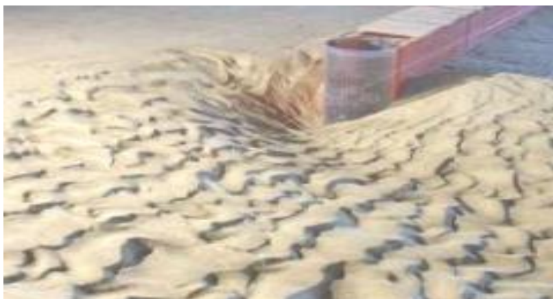
Figura 10. Socavación alrededores de un estribo
