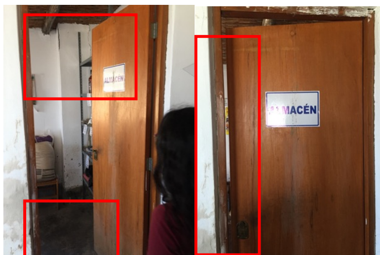
Instalaciones que requieren mejoras y mantenimiento
