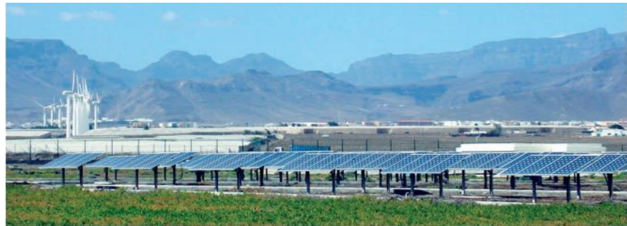
Figura 8. Paneles solares fotovoltaicos
