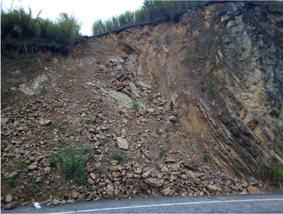
Anexo 4: Falla en Talud estabilizado con shotcrete. Fuente Propia
