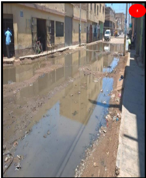
Fig.20.05 Colapso de redes de alcantarillado, Calle los Álamos y Los Cedros, Upis primero de mayo-Sector I Fuente: Propia
