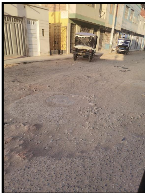
Fig.22.02. Pavimento deteriorado en la Avenida Balta, Upis primero de mayo-Sector I Fuente: Propia
