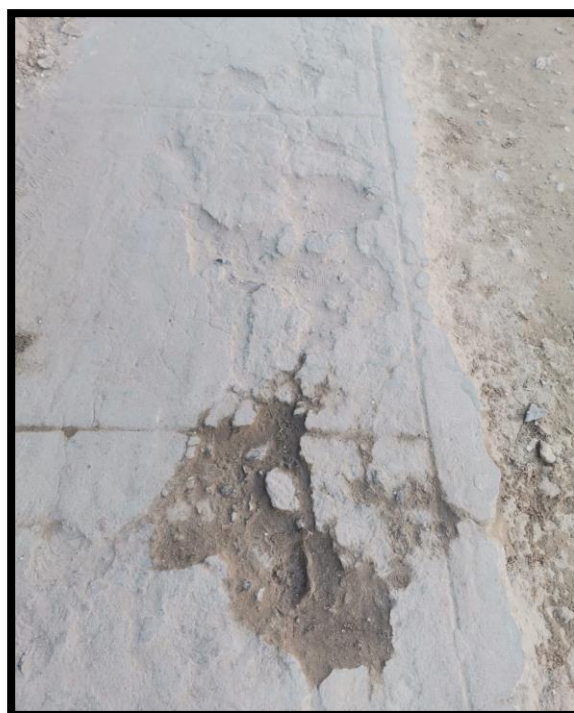
Fig.23.04. Veredas en mal estado – calle Próceres, Upis primero de mayo-Sector I Fuente: Propia
