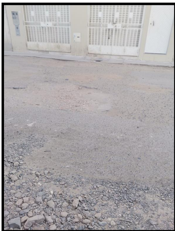
Fig.22.01. Pavimento deteriorado en la Avenida Balta, Upis primero de mayo-Sector I Fuente: Propia
