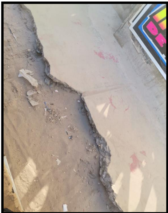
Fig.23.03. Veredas en mal estado – Avenida Balta, Upis primero de mayo-Sector I Fuente: Propia
