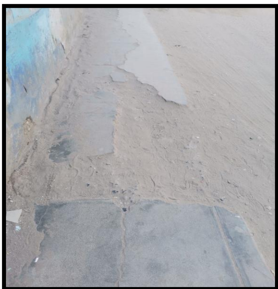
Fig.23.01. Veredas en mal estado – calle Húsares de Junín, Upis primero de mayo-Sector I Fuente: Propia
