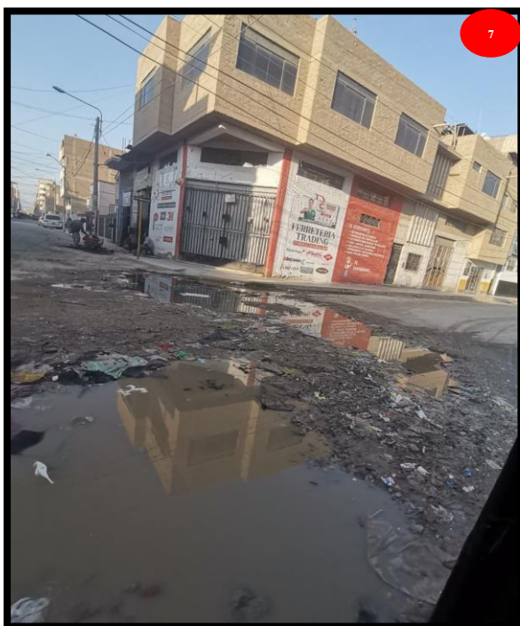
Fig.20.07. Colapso de redes de alcantarillado, Calle Carolina y Huáscar, Upis primero de mayo-Sector I Fuente: Propia
