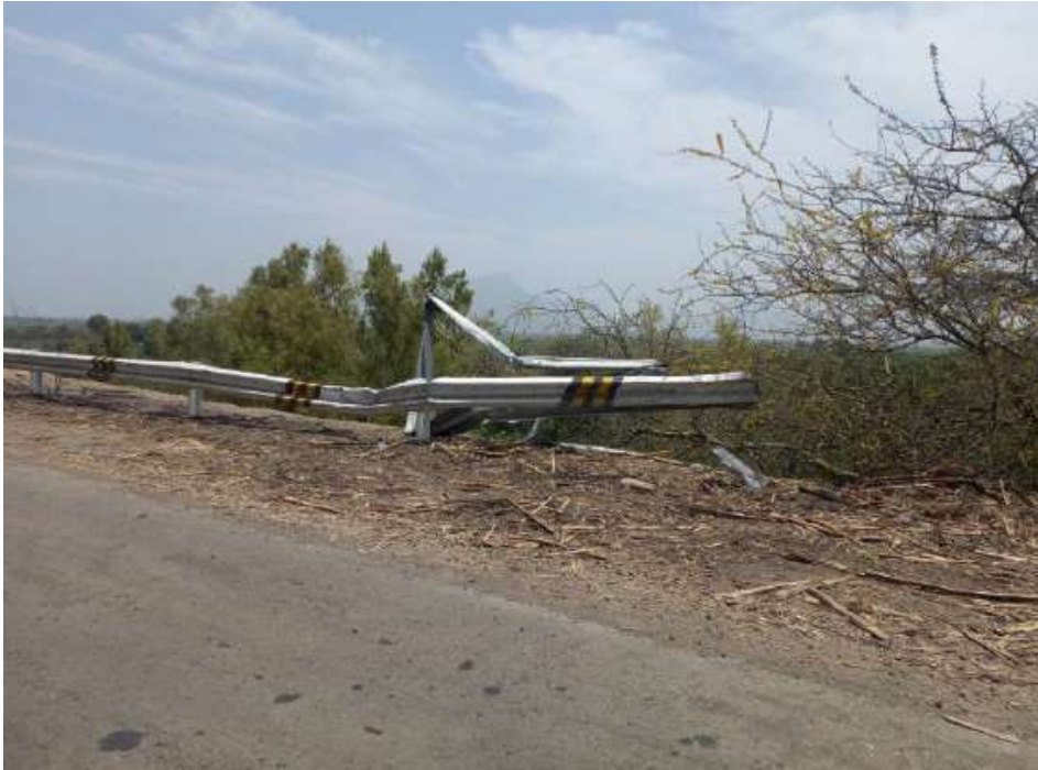
FIGURA N° 69: Guardavías en mal estado Km 29+000
