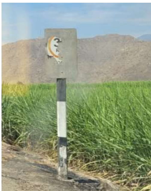
FIGURA N° 13: Señalización vertical deteriorada
