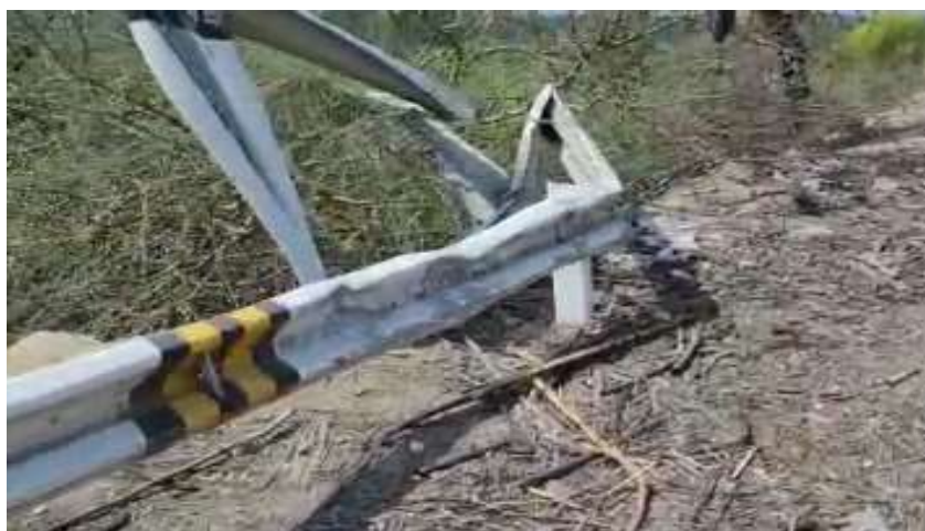
FIGURA N° 15: Guardavía metálica deteriorada
