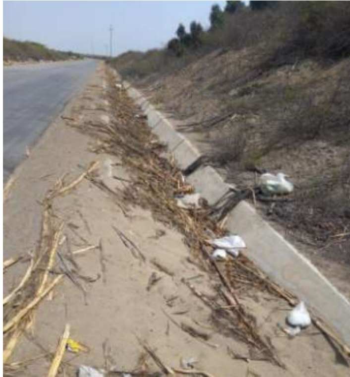
FIGURA N° 67: Colmatación de cunetas Km 3+000 con residuos de basura
