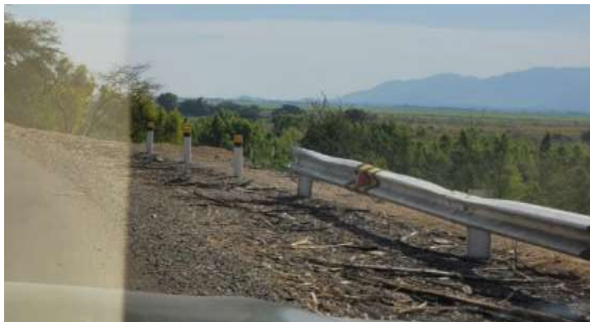
FIGURA N° 14: Guardavía metálica incompleta
