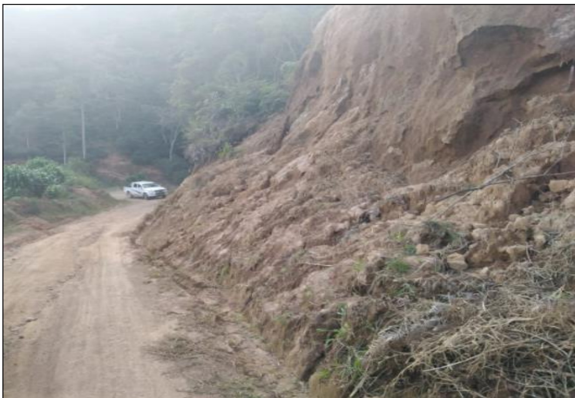
fotografía 6 Derrumbo – Obras de Arte Desanche
