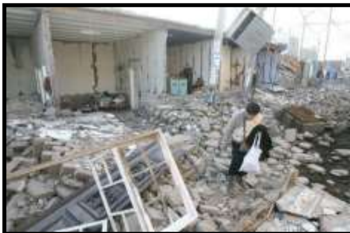
Fig. 2 Daño de clase 05 (Colapso) en viviendas de adobe en Pisco por el sismo de Ica de 2007
