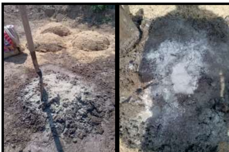
Fig. 66 De izquierda a derecha: Aplicación de la cantidad óptima del aditivo sólido Solidry. Aplicación de las diversas dosificaciones en porcentajes del óxido de calcio en la mezcla de adobe
