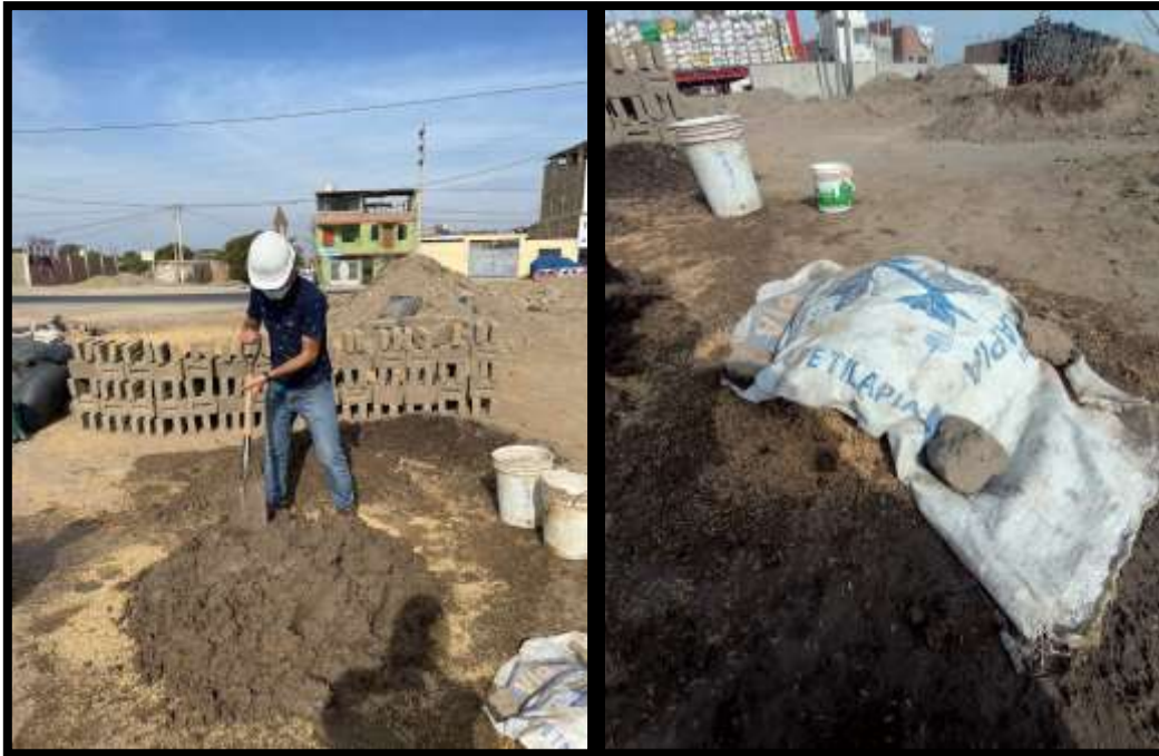
Fig. 48 De izquierda a derecha: Elaboración de la mezcla de tierra, agua y paja con ayuda de una pala. Cubierta del morro de mezcla para protegerlo durante las 24 horas de secado
