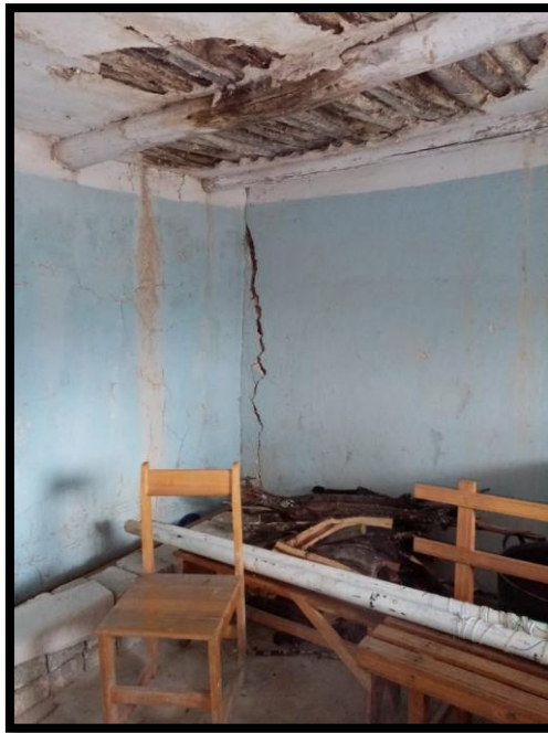
Imagen 36: Vivienda de adobe por el interior con presencia de fallas en las paredes y techo en el Distrito de Chalamarca. Fuente: Propia
