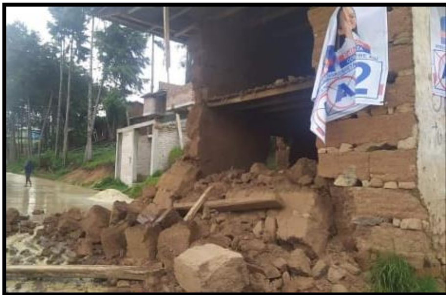
Imagen 34: Vivienda de adobe colapsada en el Distrito de Chalamarca. Fuente: Propia
