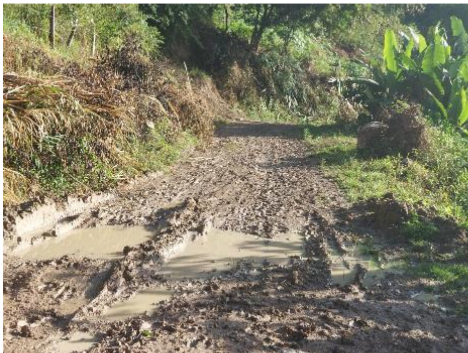
Ilustración 4: Subrasantes en mal estado.
