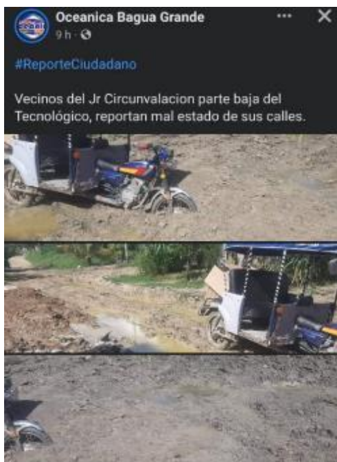
Ilustración 2: Las autoridades realizan los mantenimientos, pero sin estabilizantes químicos que mejoren las propiedades del suelo.
