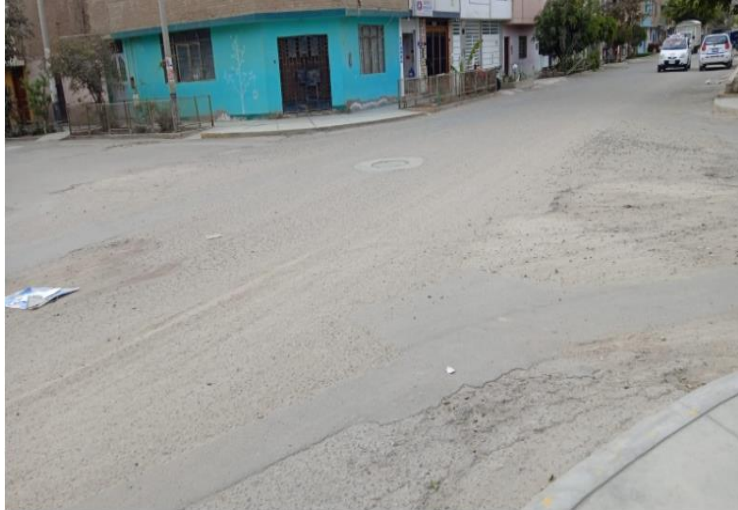
Foto 1.3.1: Desprendimiento de agregados
