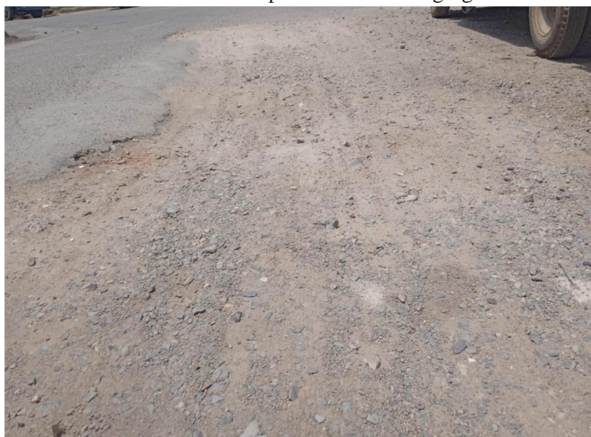
Foto 1.10.2: Desprendimiento de agregados
