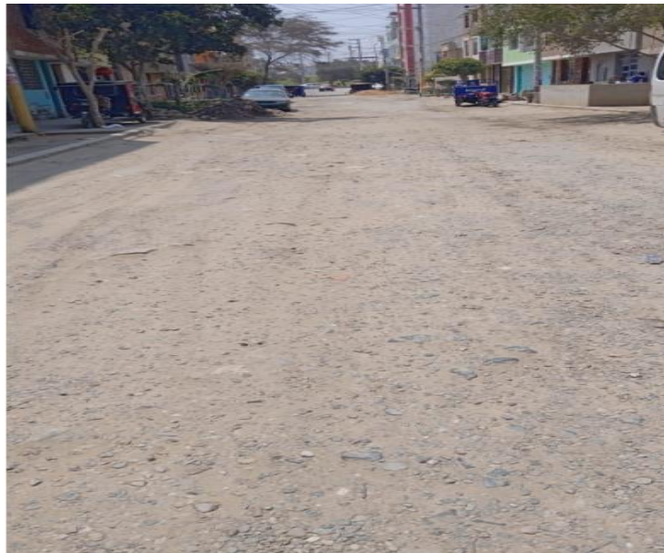
Foto 1.3.2: Desprendimiento de agregados
