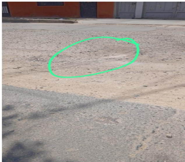
Foto 1.4.3: Desprendimiento de agregados y hueco
