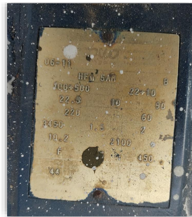
Ilustración 1. Placa de bomba del área de bungalows, cocina, barra
