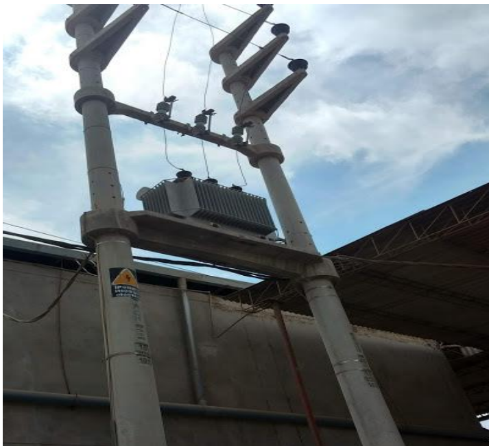
Fig. 49: Sub Estación mono poste A.
