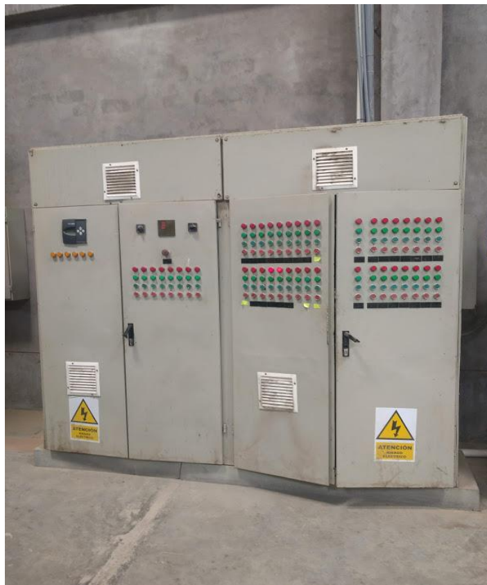
Fig. 43. Tableros de distribución.
