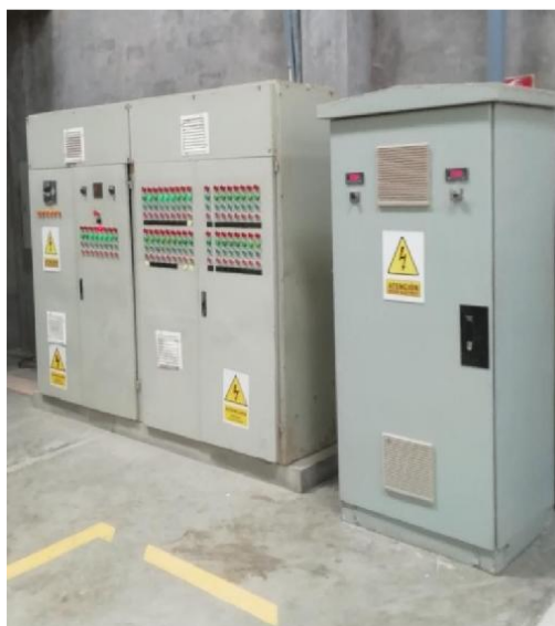
Fig. 60: Gabinete del sistema de distribución y su banco de condensadores.
