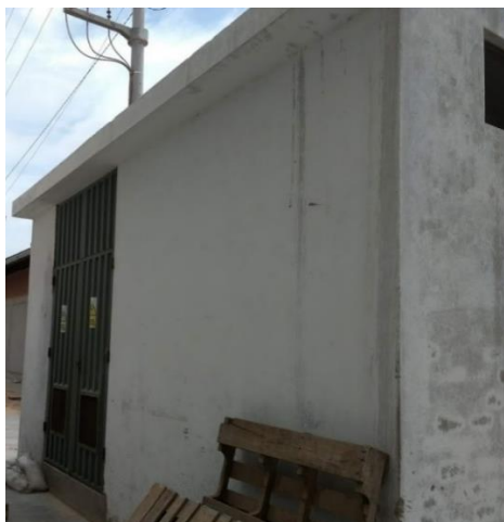
Fig. 53: Sub estación de caseta C.
