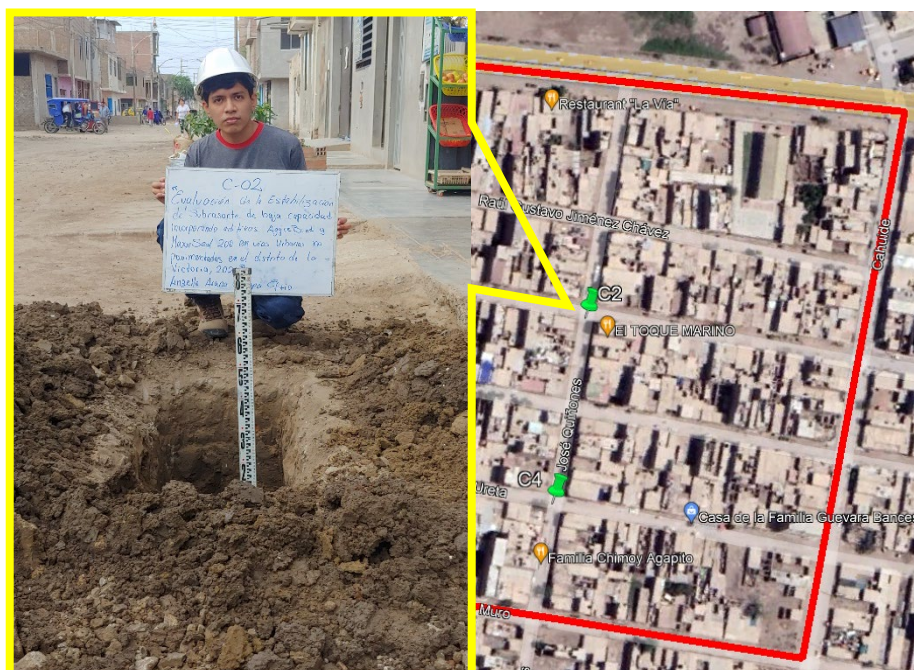
Figura 4. Calicata 02 – Calle Antonio Raymondi y José Quiñones
