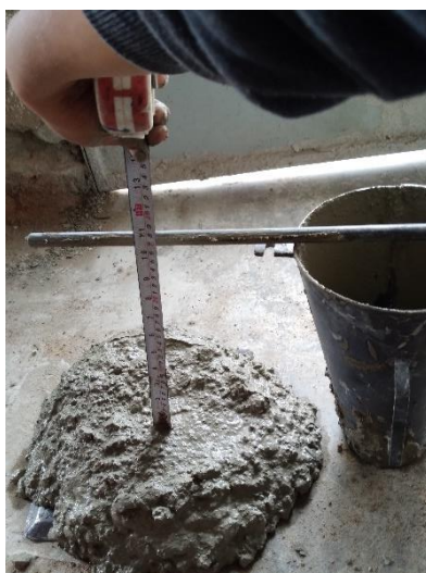
Ilustración 46: Asentamiento de la obra N°10.
