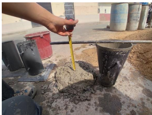
Ilustración 44: Asentamiento de la obra N°08.
