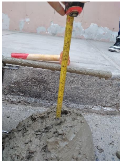
Ilustración 37: Asentamiento de la obra N°01.
