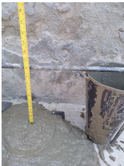
Ilustración 38: Asentamiento de la obra N°02.
