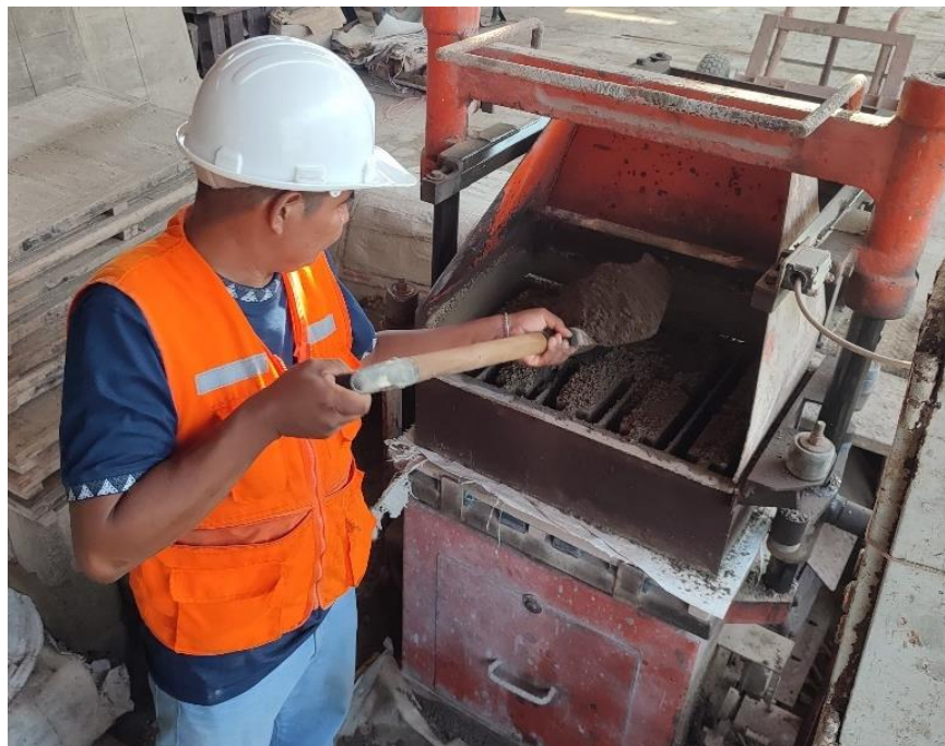
Fig. 38: Llenado con mezcla de concreto con una pala para la elaboración de los bloques
