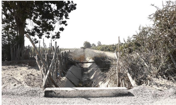
Imagen 40. Canal de regadío en mal estado. Fuente propia
