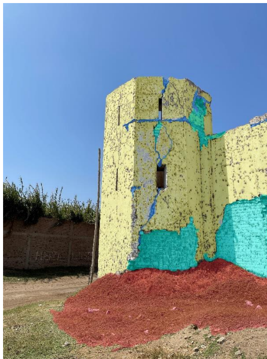
Figura 6 Patologías en torreones.
