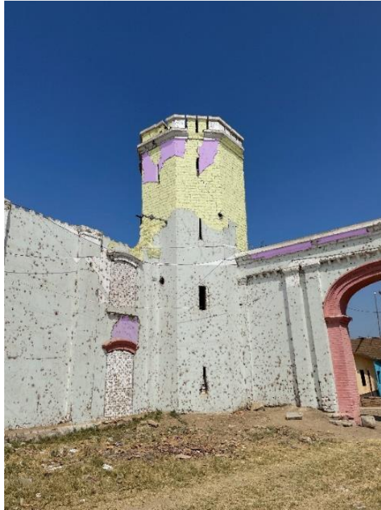
Figura 5 Patologías en torres del galpón
