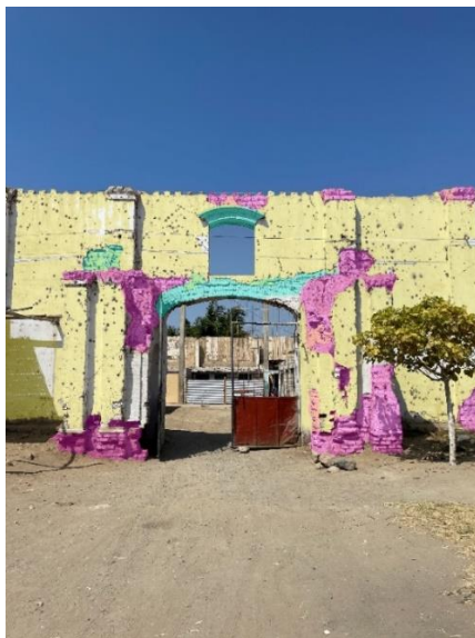
Figura 7 Patologías del acceso al galpón
