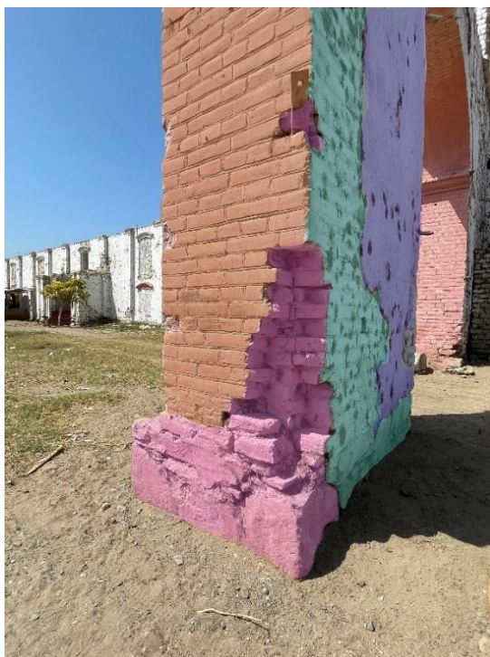
Figura 9 Patologías en columnas
