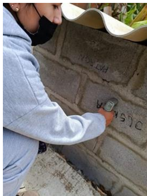
Figura N°112. Termómetro en la cara externa con 0%
