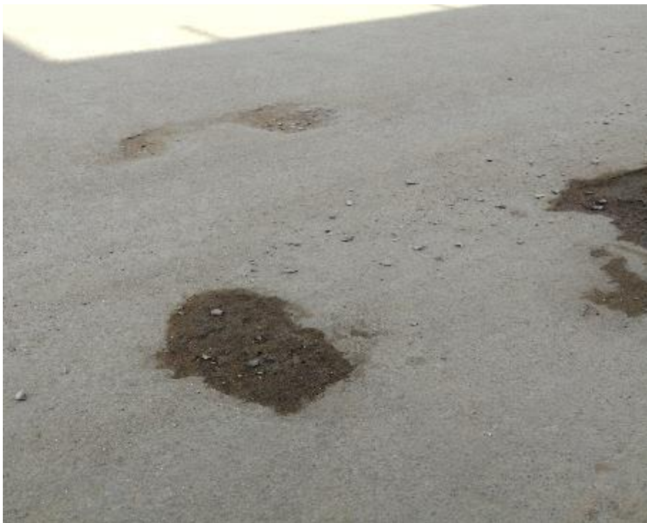
Huecos con un grado de deterioro medio
