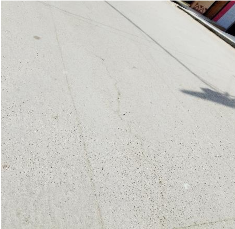
Grietas longitudinales y transversales
