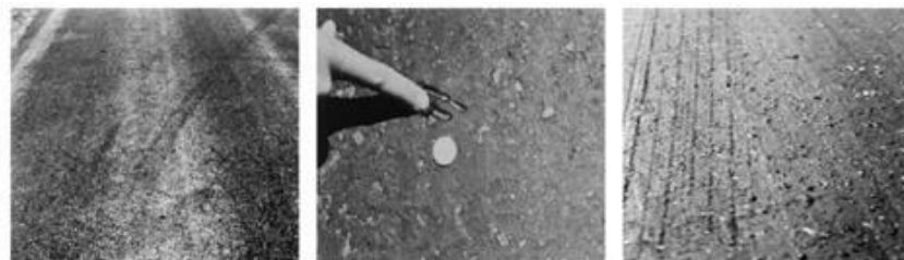
Ilustración 11. Exudación, de izquierda a derecha severidad Baja, Media y Alta
