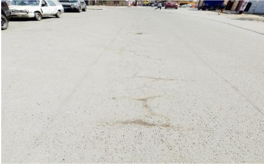
Grietas longitudinales y transversales
