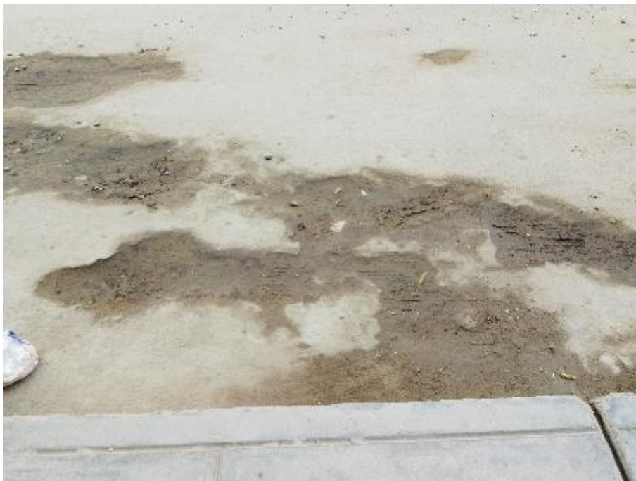
Huecos con un grado de deterioro medio y alto
