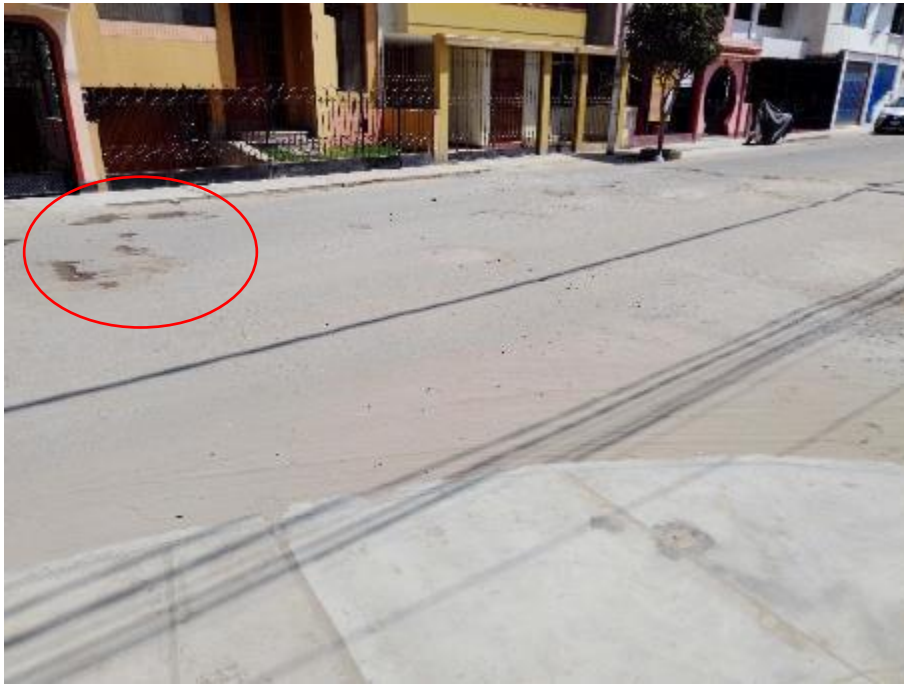
Huecos con un grado de deterioro medio
